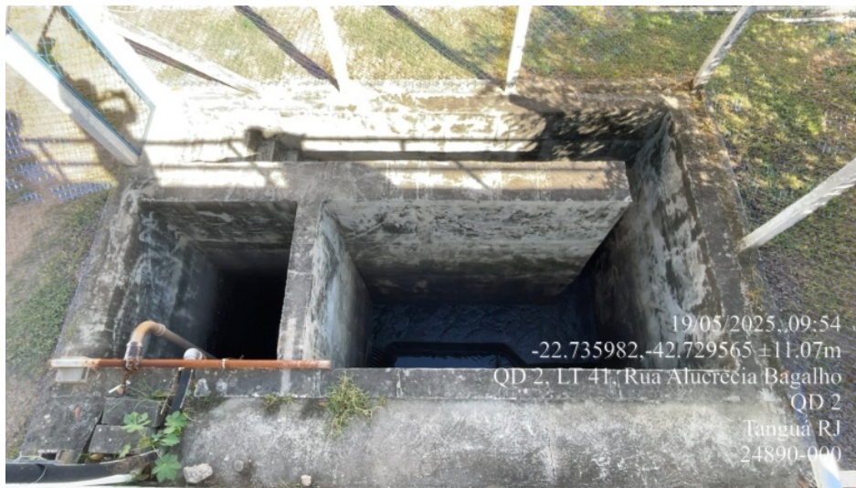
Foto 03: Chegada do esgoto bruto e gradeamento de sólidos grosseiros.
