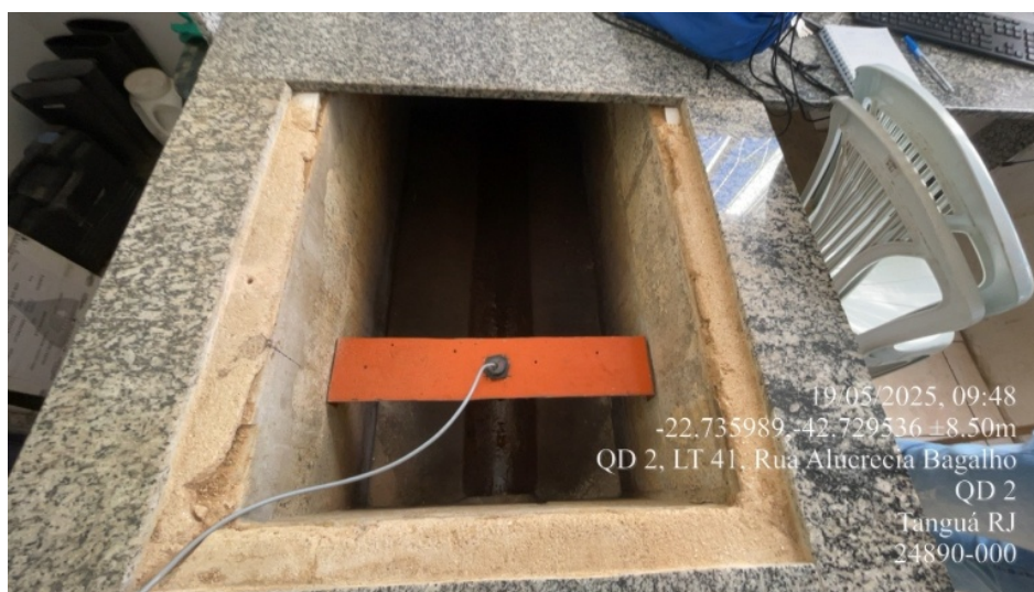
Foto 12: Saída do efluente tratado e sensor de medição.
