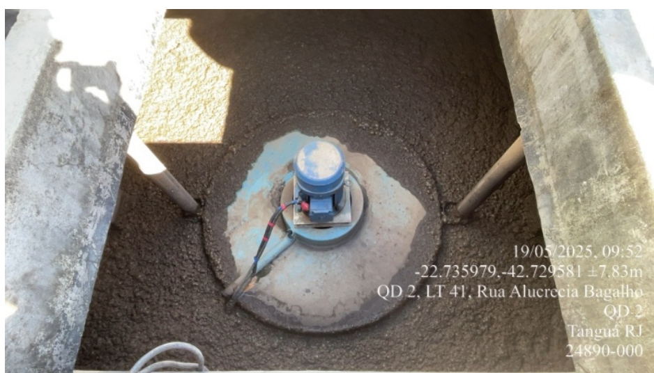
Foto 06: Tanque de aeração.
