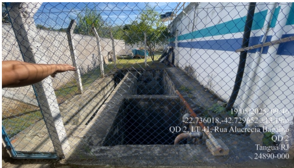
Foto 02: Chegada do esgoto bruto e gradeamento de sólidos grosseiros.
