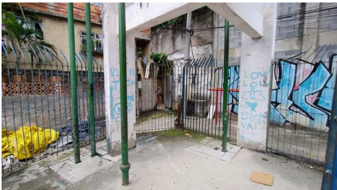
Foto 06: Tubulação de entrada, saída, extravasor e limpeza.
