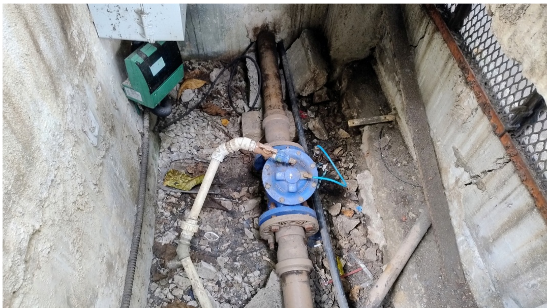
Foto 05: Rede de abastecimento de 75 mm.
