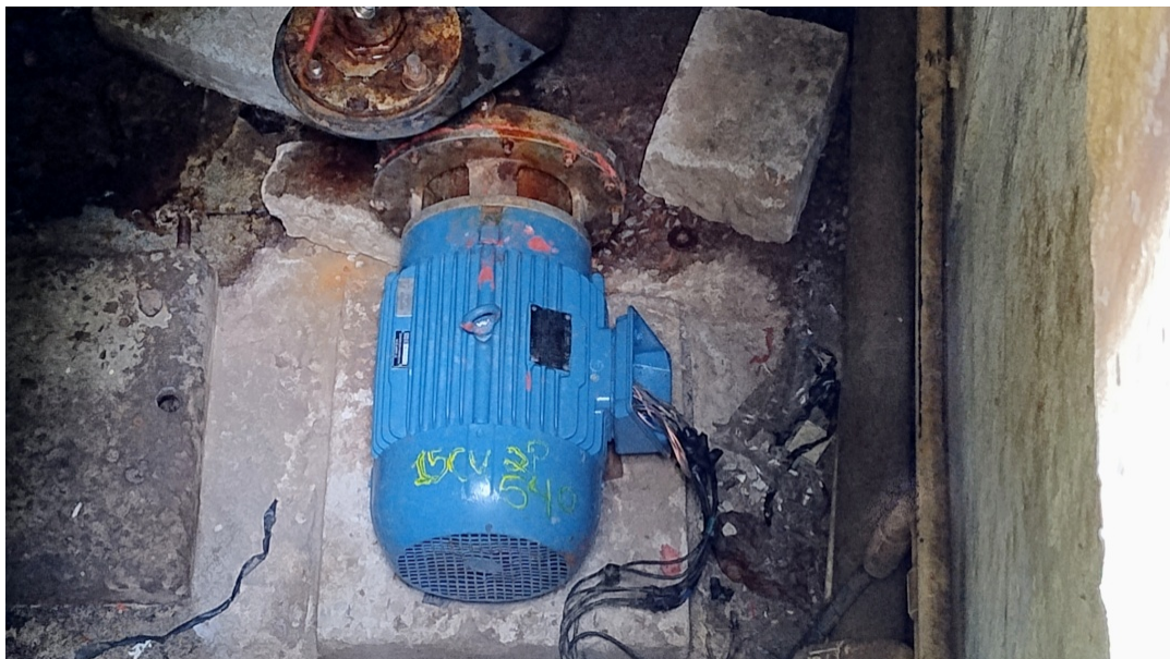
Foto 03: Bomba de 15 cv.
