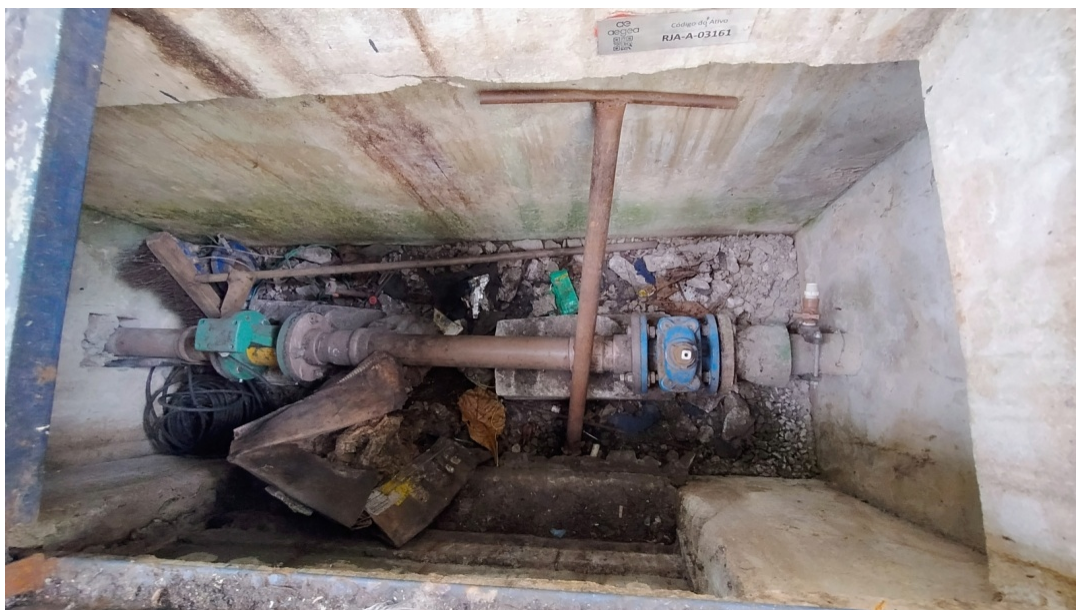
Foto 06: Acesso a válvula de manobra.
