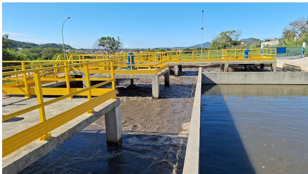
Foto 16 – Tanque de aeração com aeradores superficiais.
