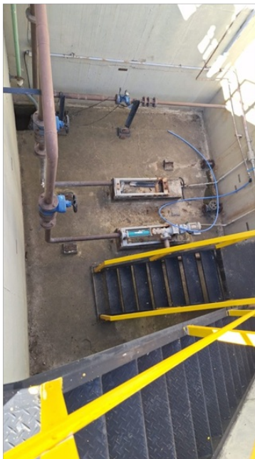
Foto 17 – Elevatória de lodo sedimentado.
