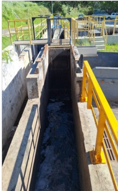
Foto 5 - Gradeamento fino (limpeza manual).
