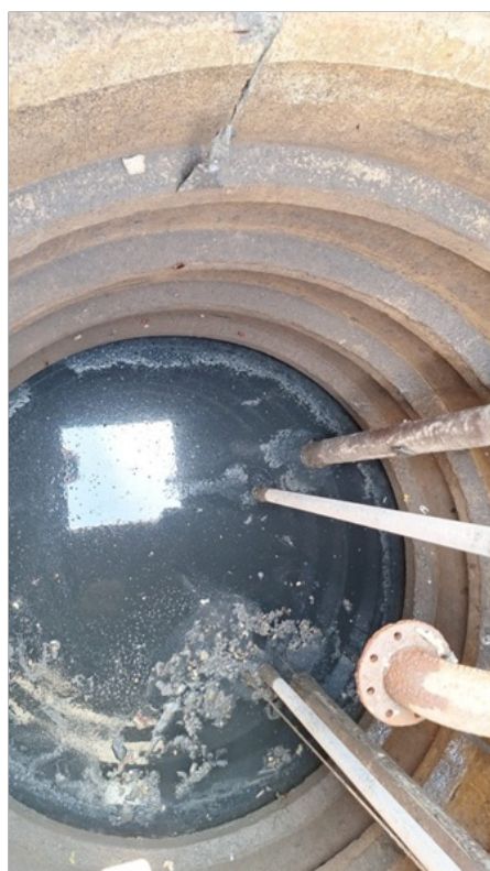
Foto 2 – Vista do poço da EEE com 2 bombas submersíveis e 2 recalques.
