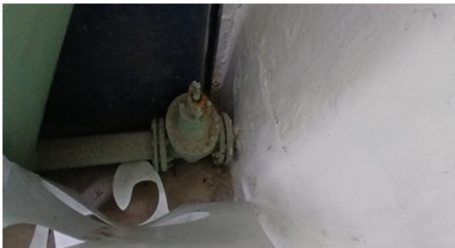
Foto 17 – Tubulação de limpeza
