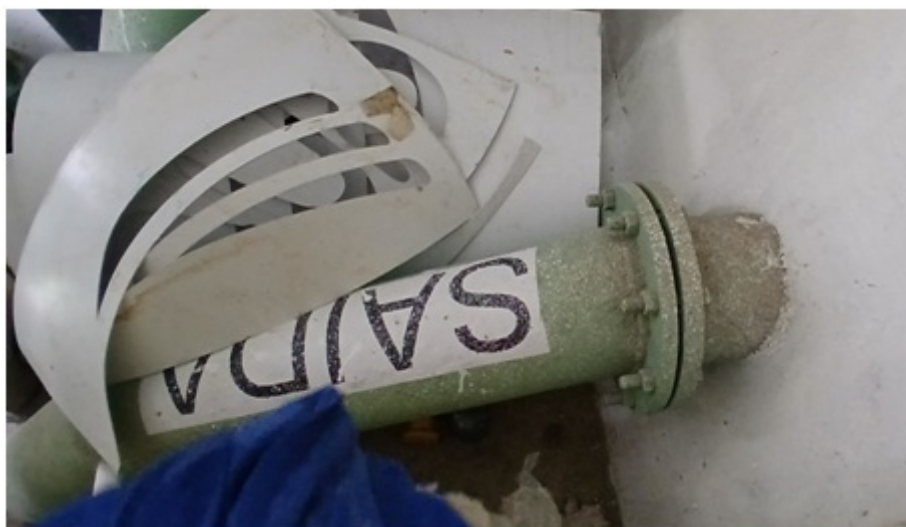
Foto 15 – Tubulação de distribuição
