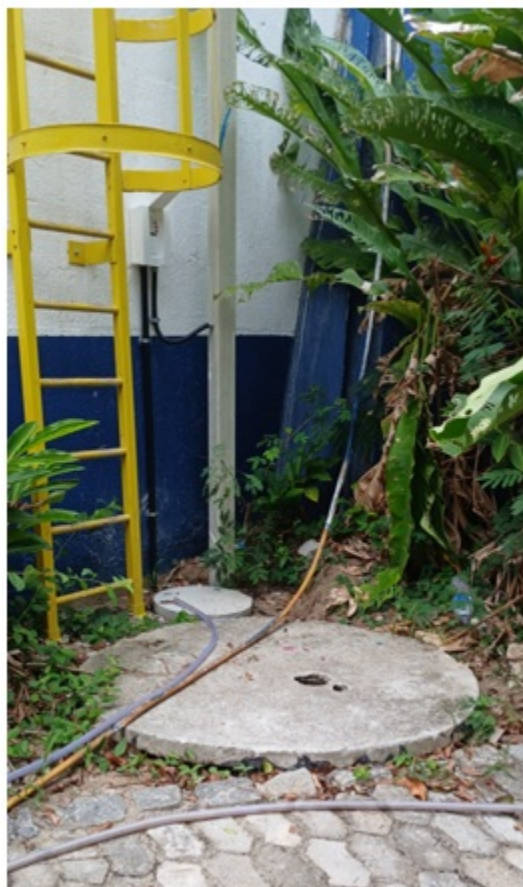
Foto 19 – Caixa da válvula da tubulação de recalque
