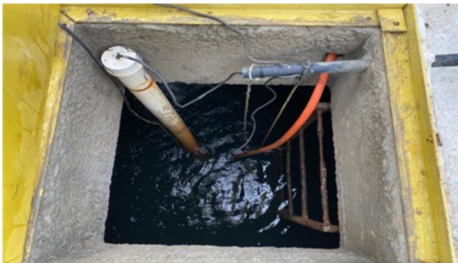
Foto 10 – Água no interior do reservatório
