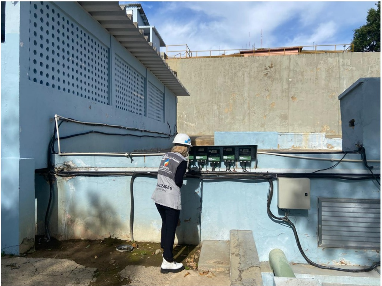
Foto 8 – Macromedidores de entrada e de saída.
