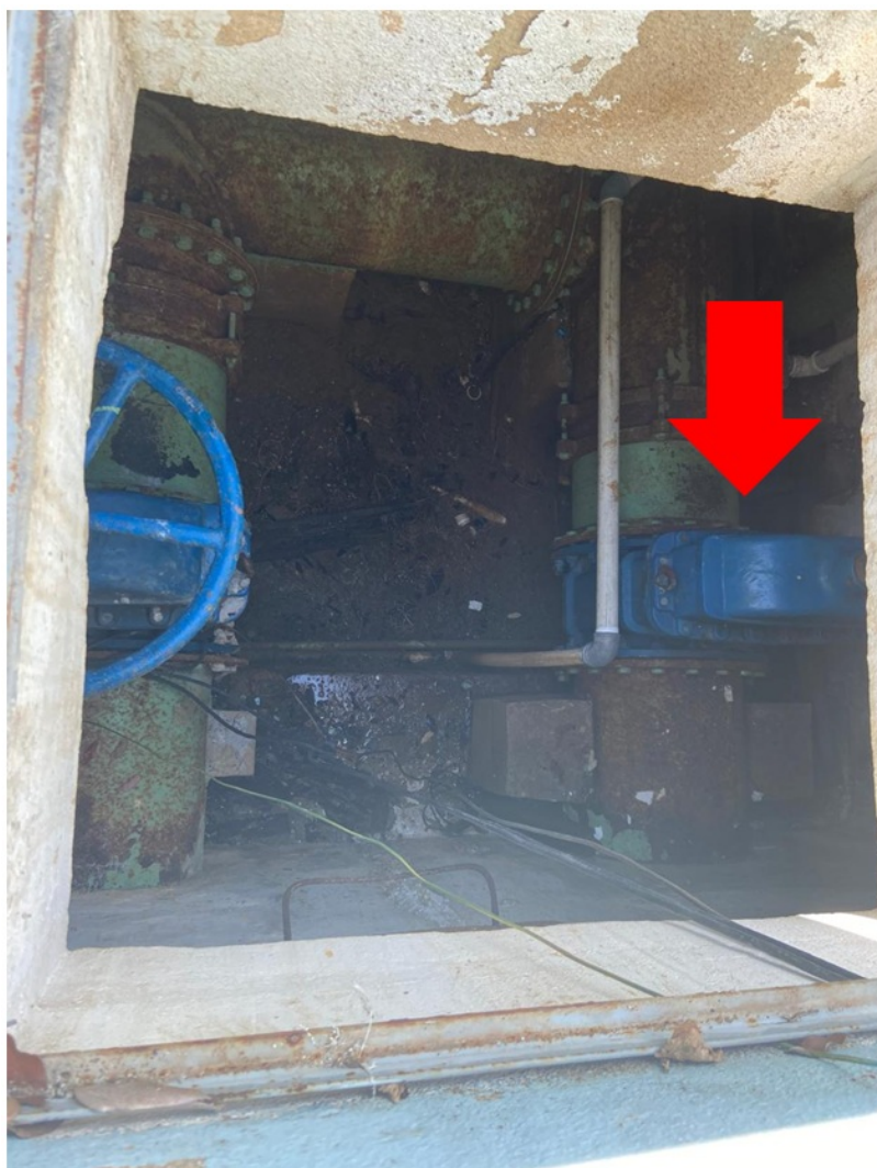
Foto 5 – Tubulação de saída em bom estado de conservação.
