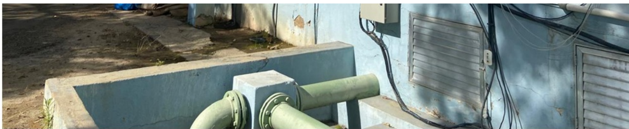
Foto 1 – Reservatório com identificação encontra-se no pátio interno da ETA.
