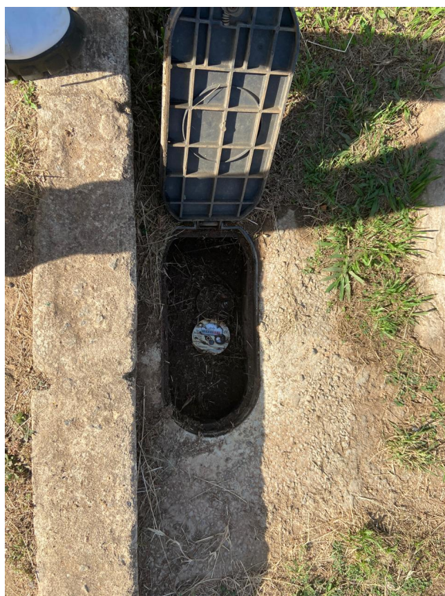
Foto 2 – Macromedidor de saída.
