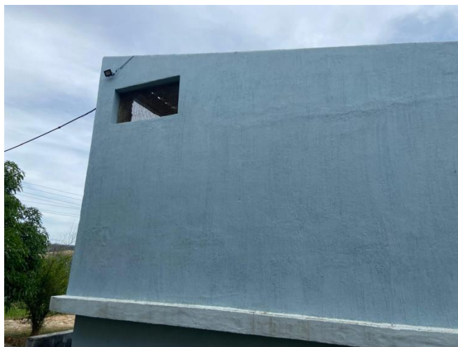
Foto 04 – Janela de ventilação com tela protetora.
