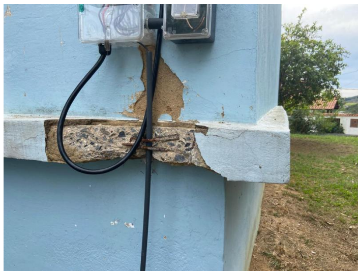
Foto 2 – Ferragens aparentes na parede externa.
