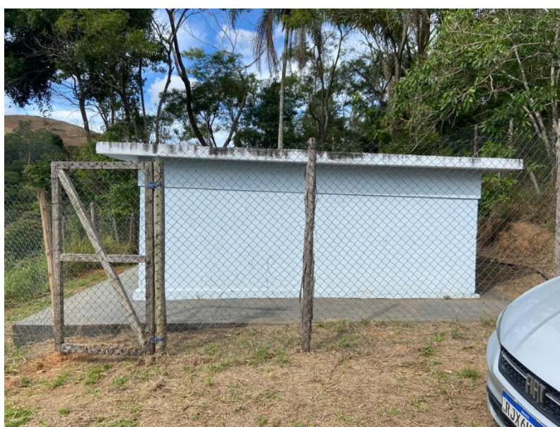
Foto 2 – Reservatório sem identificação.
