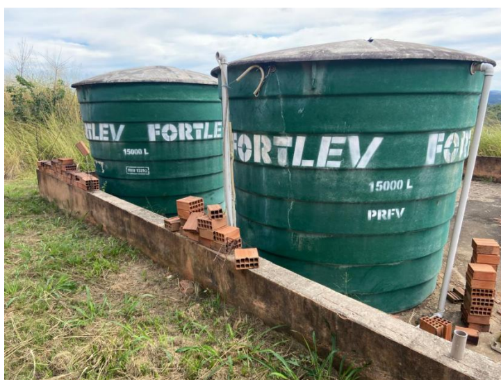
Foto 2 – Reservatório sem identificação.
