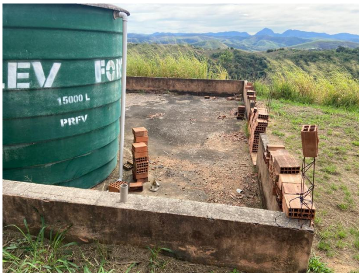
Foto 1 – Área do reservatório não é delimitada por nenhum tipo de cercamento.
