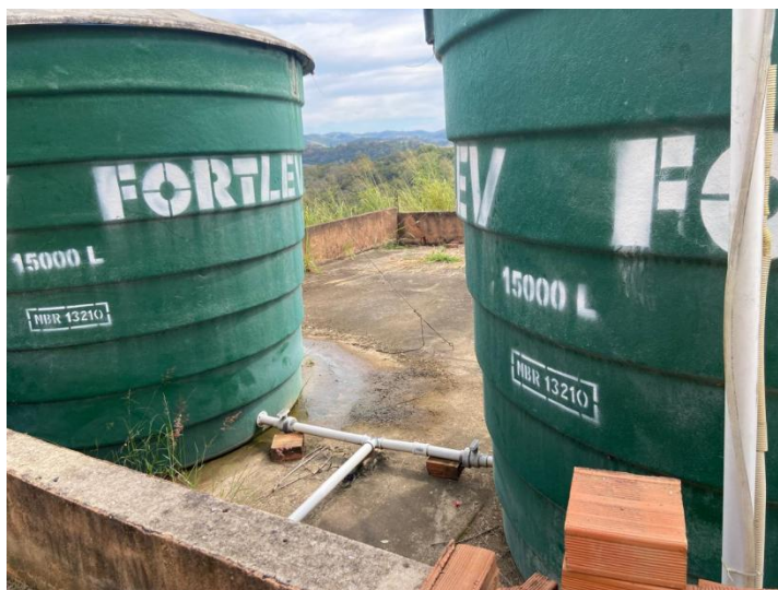
Foto 4 – Não possui macromedidores.
