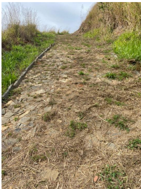
Foto 3 – Estrada de acesso ao Reservatório necessita de melhorias.
