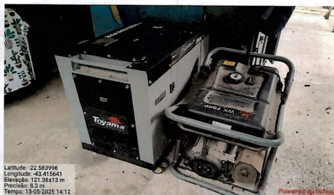
Foto 40: Gerador de energia.
