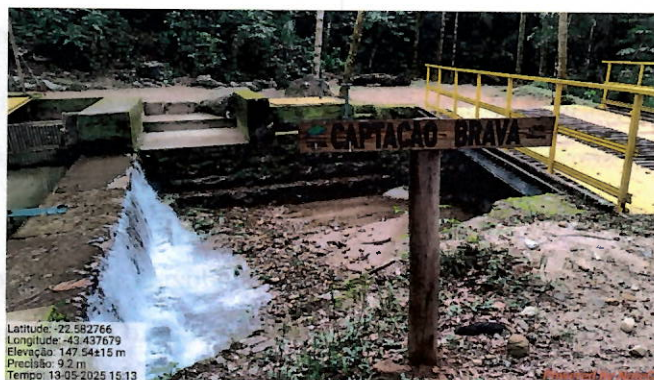
Foto 23: Placa de identificação da captação.
