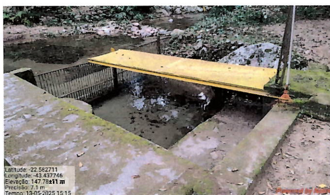
Foto 26: Plataforma de acesso ao gradeamento.
