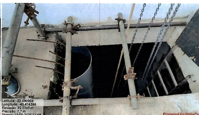
Foto 46: Reservatório de água tratada.
