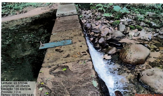
Foto 10: Represa de Macuco (comporta instalada).
