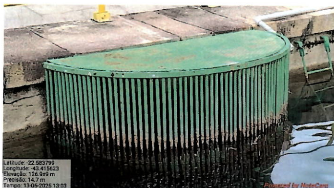
Foto 38: Gradeamento com sinais de corrosão.
