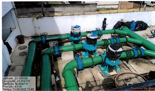
Foto 44: Estação elevatória de água tratada.
