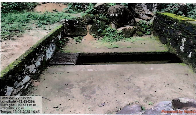
Foto 12: canal de transporte até o gradeamento.
