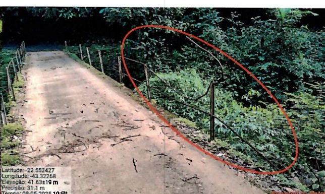
Foto 2: Ponte necessitando de guarda-corpo.
