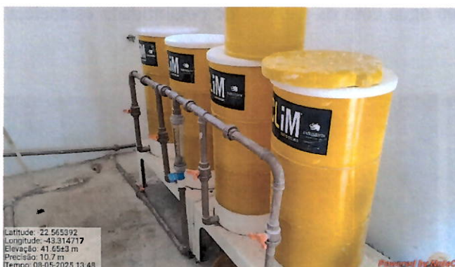
Foto 46: Sistema de desinfecção reserva.
