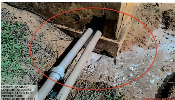
Foto 29: Saída de Efluentes de lavagem da casa de química.
