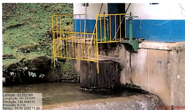
Foto 8: Gradeamento da captação da barragem inferior.
