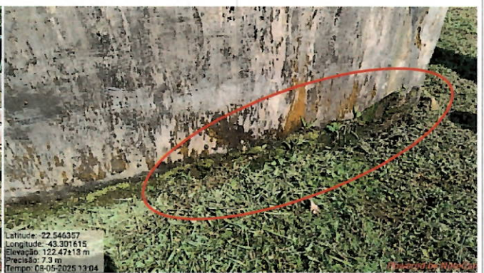
Foto 20: vazamento na caixa de inspeção/amortecimento.
