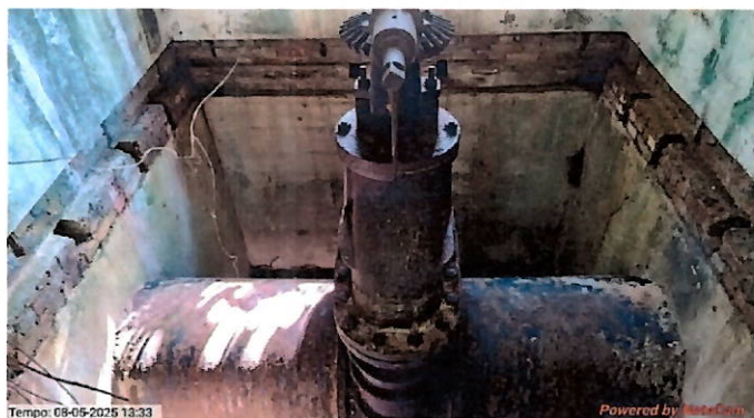
Foto 33: válvula de bloqueio (resíduos removidos do local).
