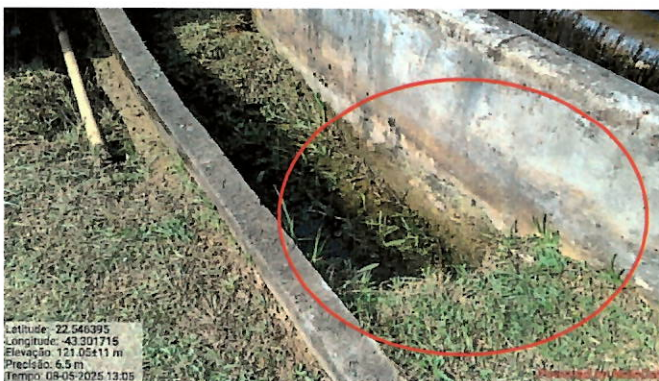
Foto 23: Vazamento na parede do decantador.
