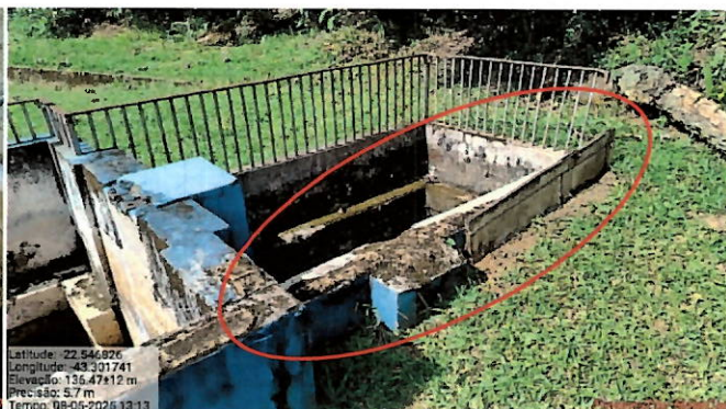
Foto 26: Trecho com ausência de guarda-corpo.
