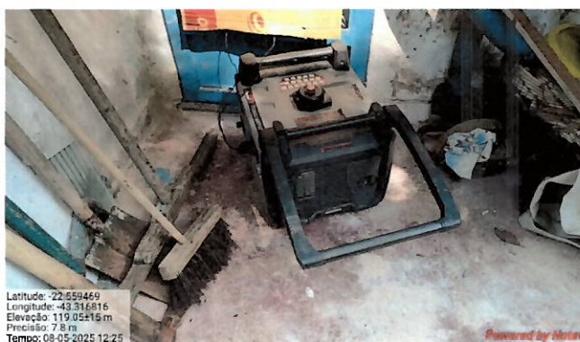
Foto 42: Gerador de energia elétrica.
