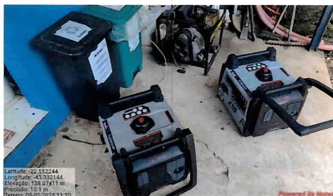
Foto 10: Geradores de energia no local.
