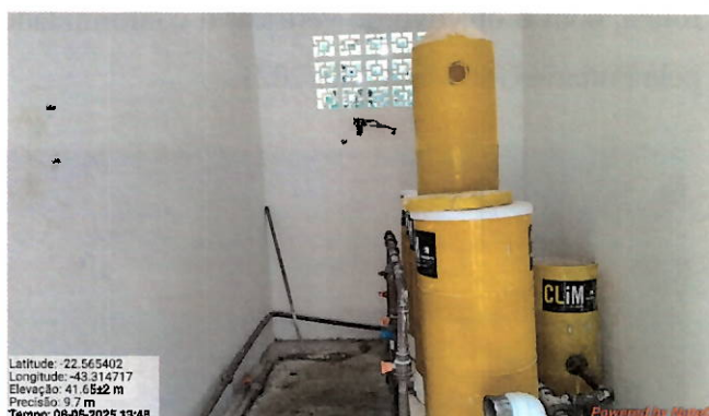
Foto 47: Sistema de desinfecção reserva.
