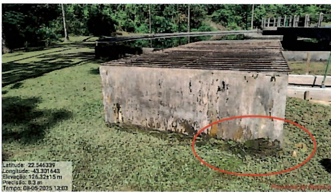
Foto 19: vazamento na caixa de inspeção/amortecimento.
