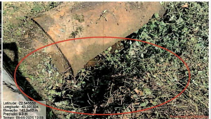
Foto 18: Vazamento de água no muro da barragem próximo a adutora.
