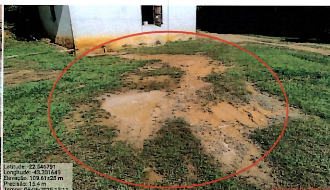
Foto 30: solo encharcado com efluentes de lavagem da casa de química.
