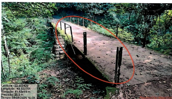
Foto 1: Ponte necessitando de guarda-corpo.
