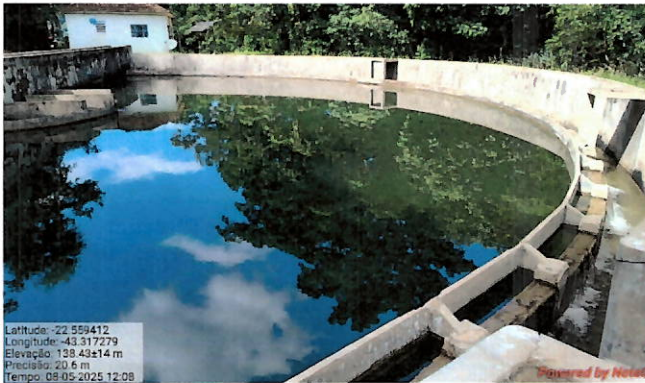
Foto 38: Tanque de decantação da UT Xerém II.
