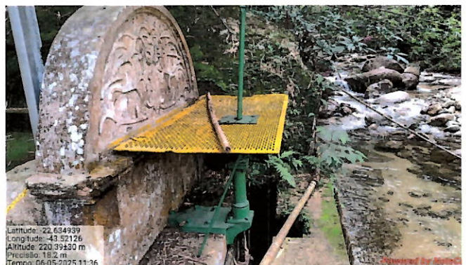
Foto 2: Entrada de água no sistema.
