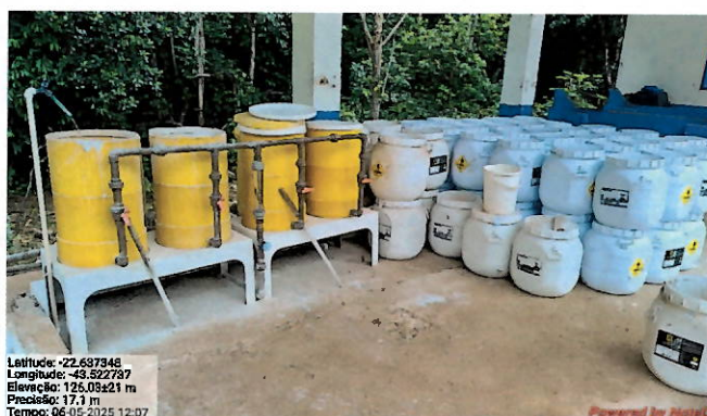
Foto 19: Armazenamento de Hipoclorito de Cálcio.
