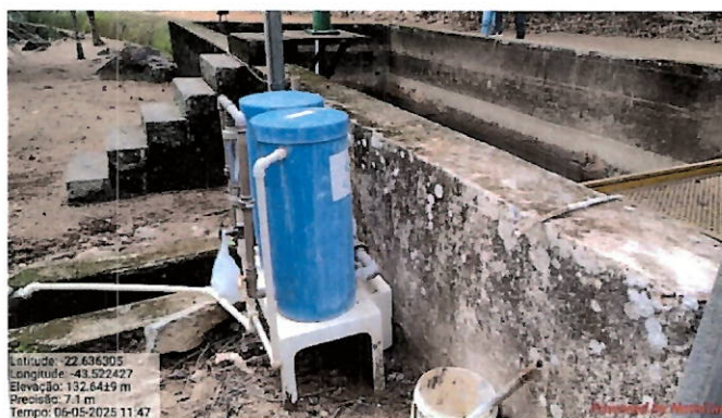
Foto 9: Sistema de pré-cloração.
