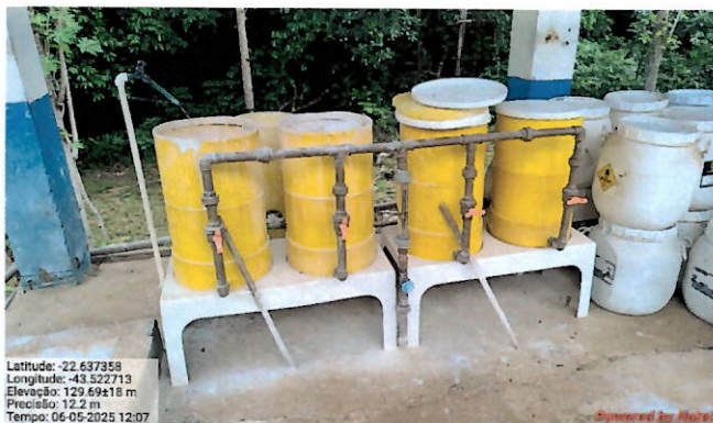
Foto 13: Sistema de desinfecção com hipoclorito de cálcio.
