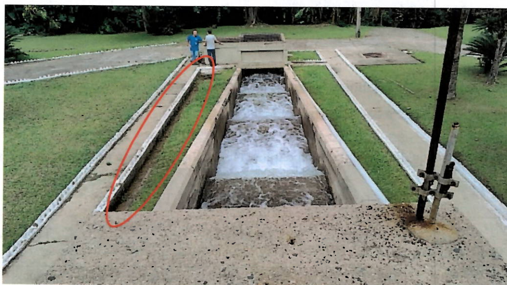
Foto 33: vazamento de água proveniente do decantador.
