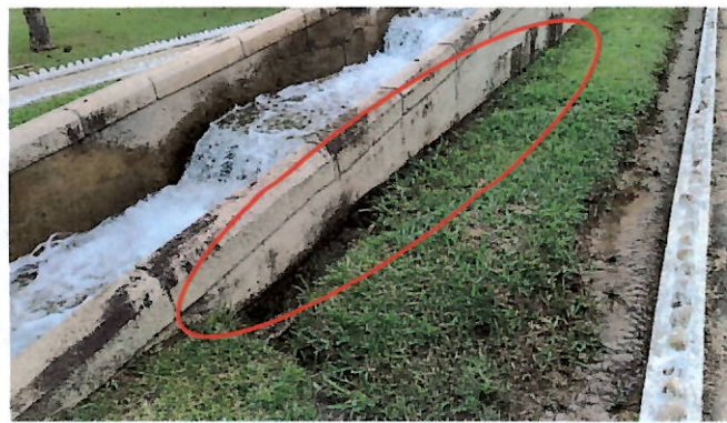
Foto 30: vazamento de água proveniente da Escada hidráulica.
