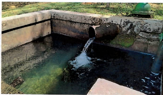
Foto 21: entrada de água na Escada hidráulica.
