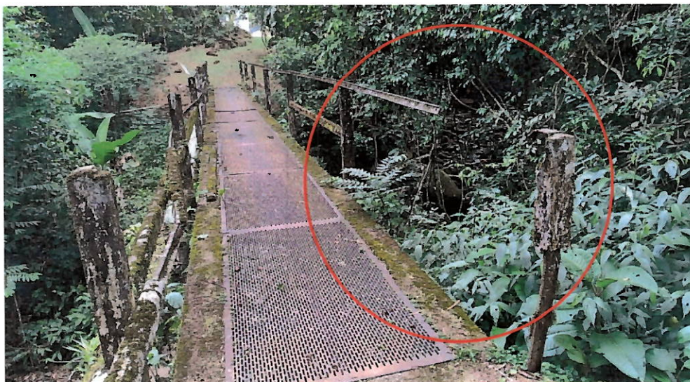
Foto 14: Pontilhão de acesso a Barragem Meio necessitando reparo no guarda-corpo.
