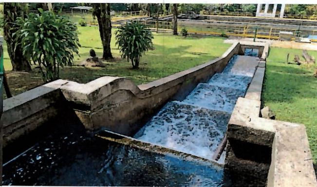
Foto 22: Escada hidráulica (entrada de água).
