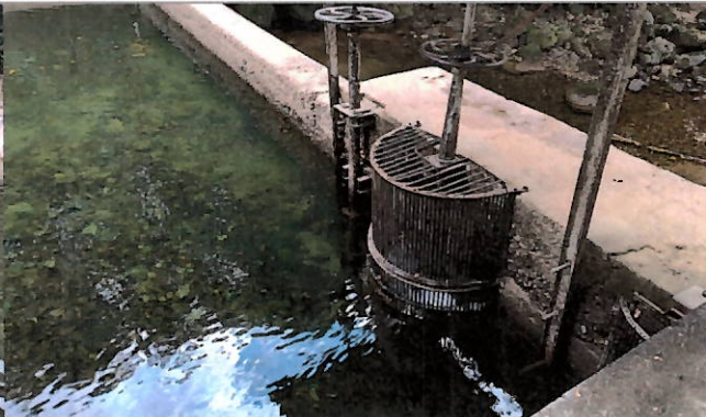
Foto 11: Sistema de abertura e fechamento de comportas.
