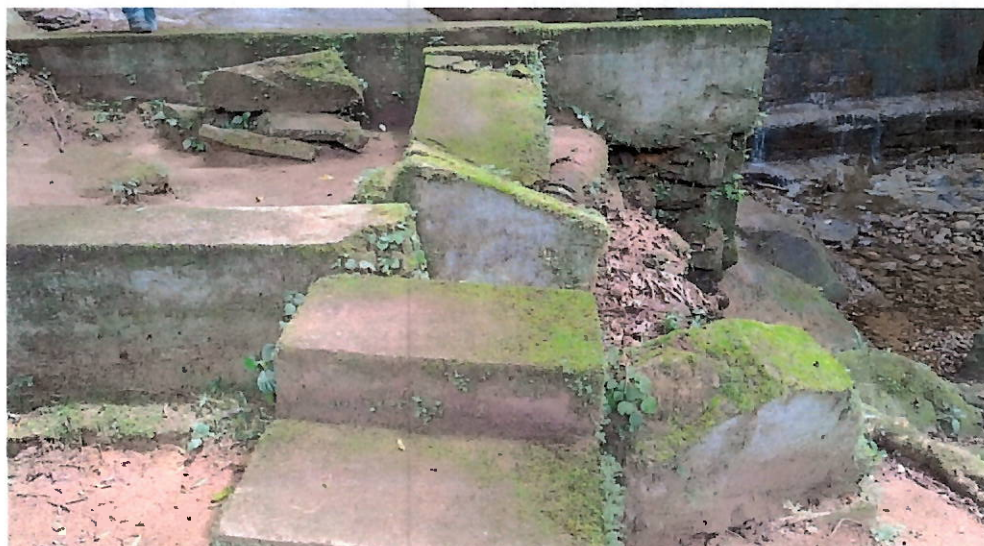
Foto 7: Trecho danificado da pequena passarela de acesso à Barragem Fazenda.
