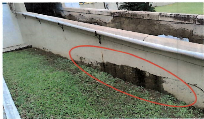
Foto 29: Infiltração de água na Escada hidráulica.
