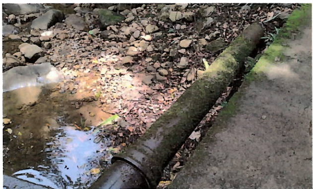
Foto 20: Adutoras de água bruta
