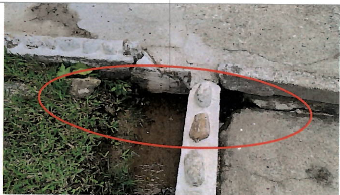
Foto 32: vazamento de água proveniente do decantador.
