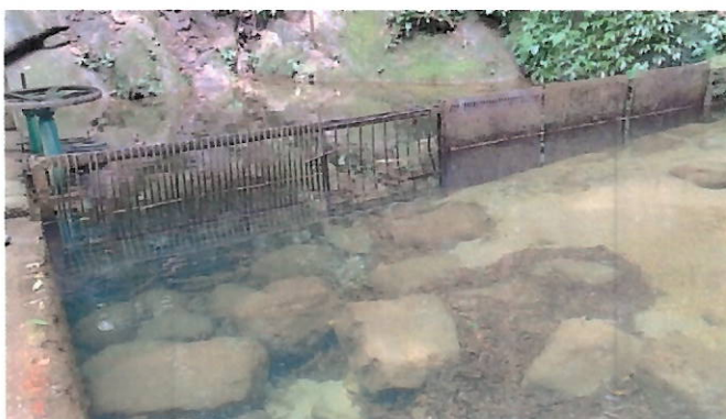
Foto 5: Entrada de água no sistema.
