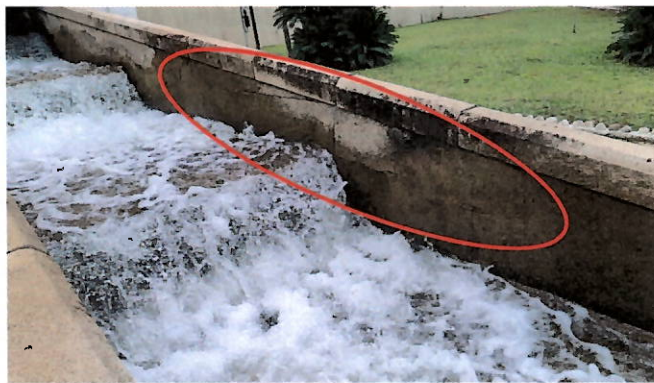
Foto 28: Escada hidráulica - estrutura necessitando de reparos .
