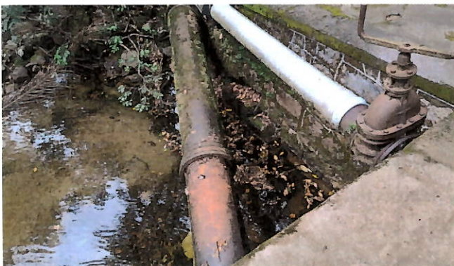
Foto 12: Adutoras de água bruta.
