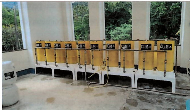
Foto 26: Sistema de cloração com hipoclorito de cálcio.
