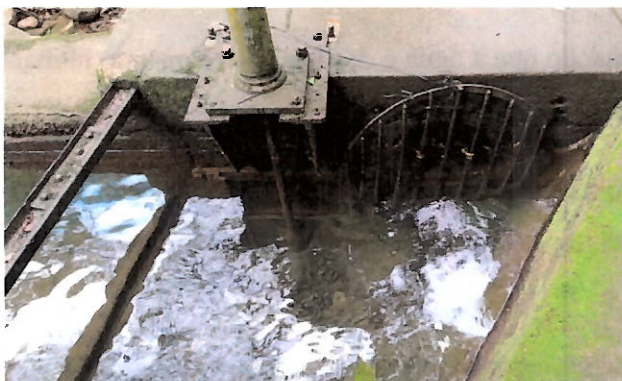
Foto 19: Entrada de água no sistema.
