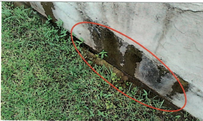
Foto 31: vazamento de água proveniente do decantador.
