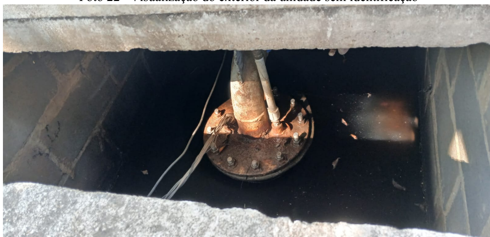
Foto 23 –Visualização do interior do abrigo subterrâneo com acúmulo de água
