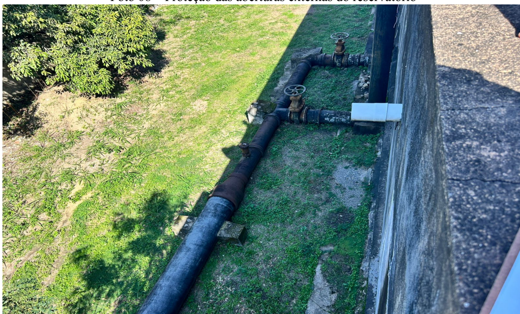
Foto 09 – Visualização da tubulação de recalque
