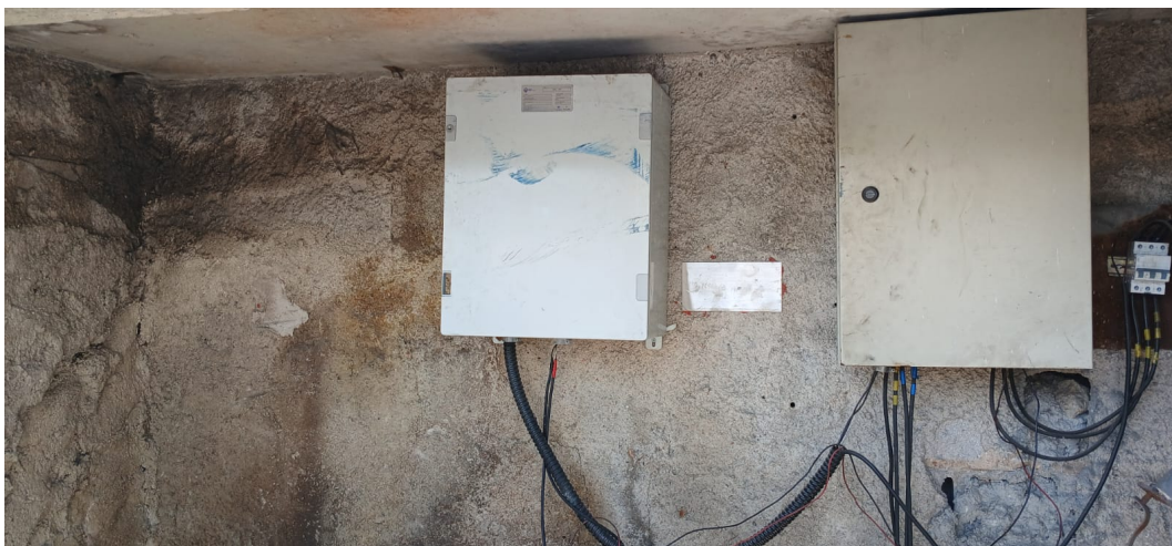
Foto 18 – Painéis elétricos sem sinalização de risco de choque elétrico
