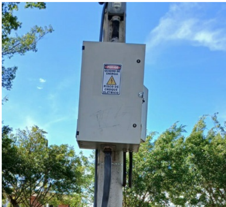
Foto 24 – Painéis elétricos com sinalização de risco de choque elétrico
