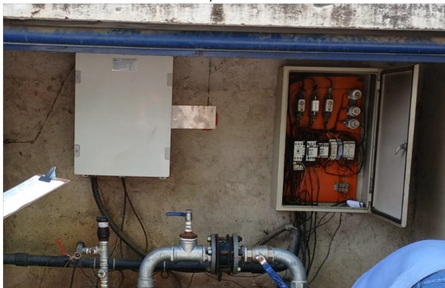
Foto 21 – Painéis elétricos sem sinalização de risco de choque elétrico
