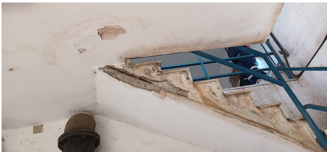
Foto 11 – Escada que dá acesso às células do reservatório com ferragem aparente
