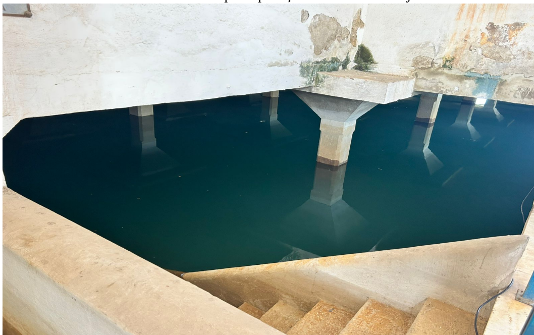
Foto 13 –Parte superior da estrutura das células deteriorada
