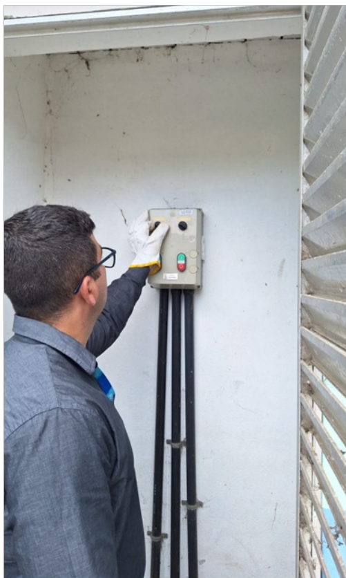
Fotos 3 – Sistema de botoeiras para operação manual da bomba da EEE .
