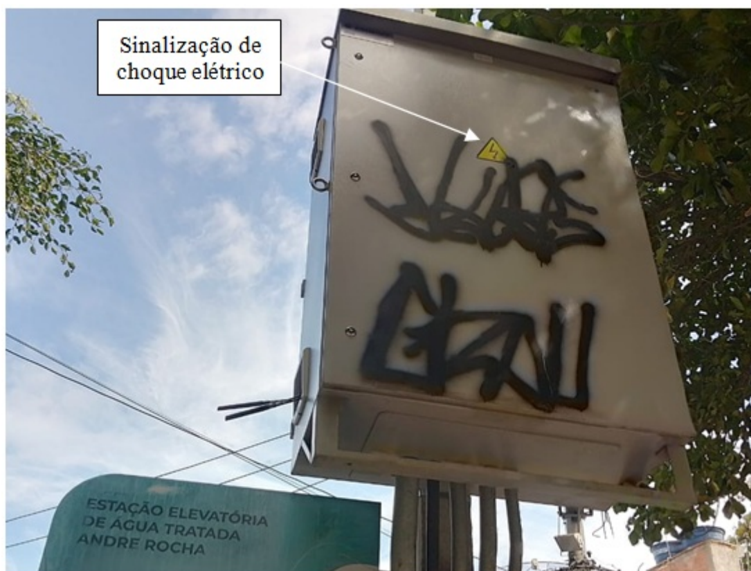
Foto 2 – Cabine e sinalização de risco de choque elétrico
