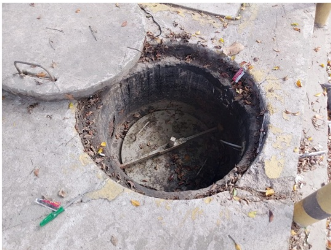
Foto 4 –Pintura desgastada em volta do abrigo da EEAT
