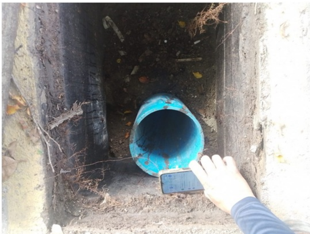
Foto 7 – Válvula na tubulação de sucção
