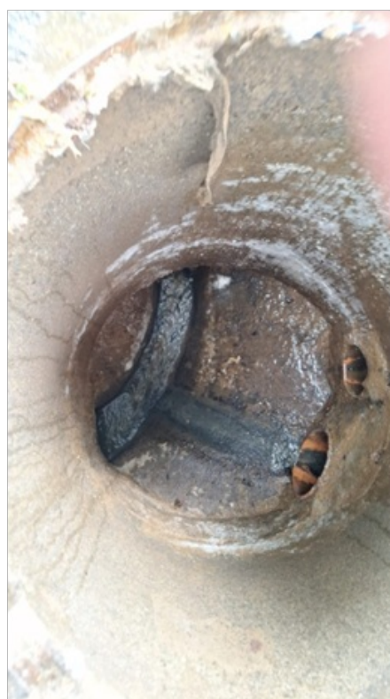
Fotos 4 – Coletor de esgotos do Condomínio ( Rua das Amoras Qd1 1A )
