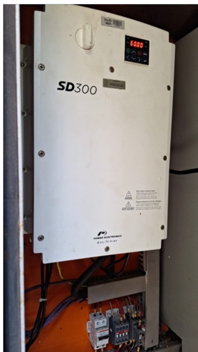
Fotos 6– Quadro elétrico.
