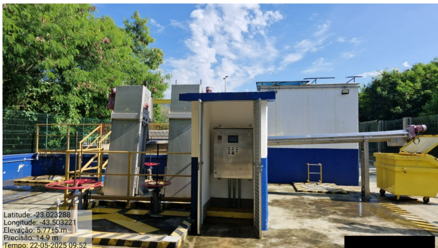
Foto 07 - abrigo para painel elétrico do gradeamento
