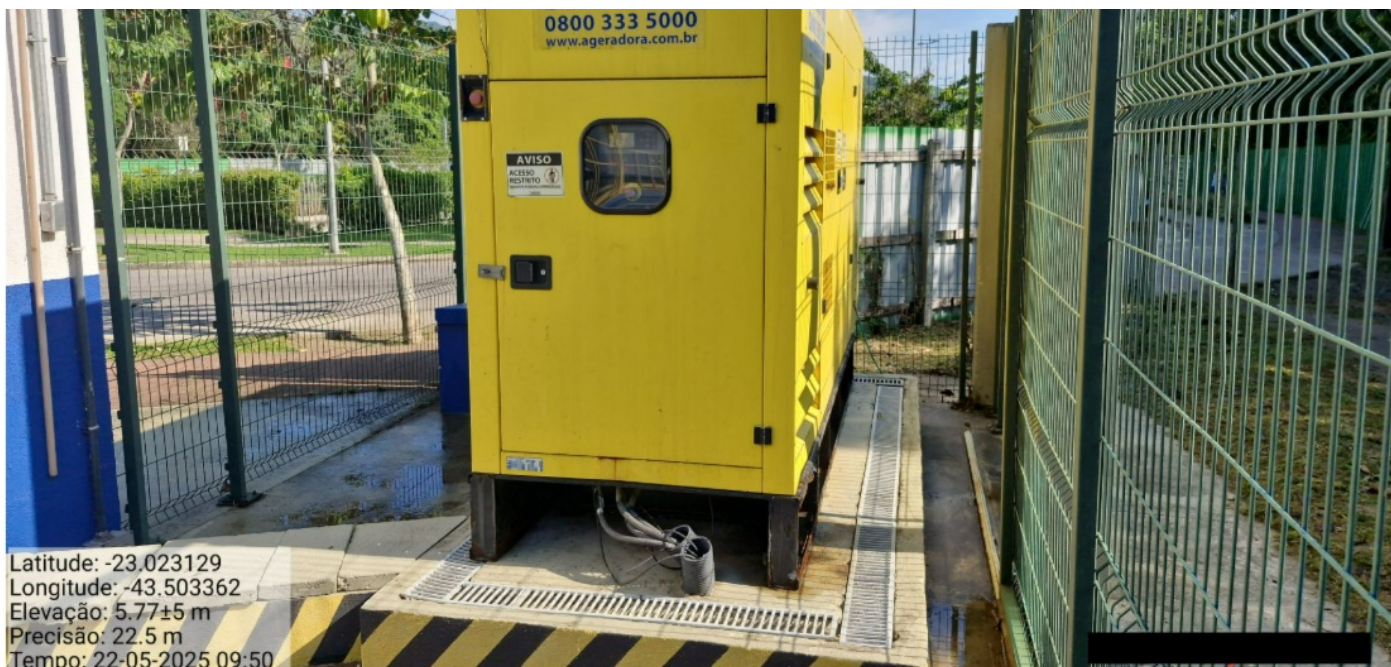
Foto 11 - gerador de energia elétrica
