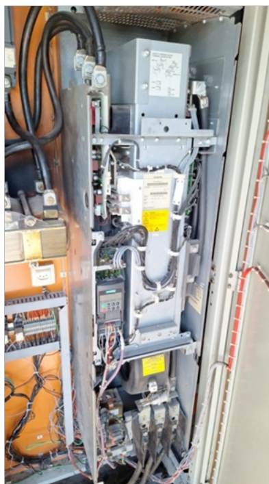
Fotos 4– Quadro elétrico.
