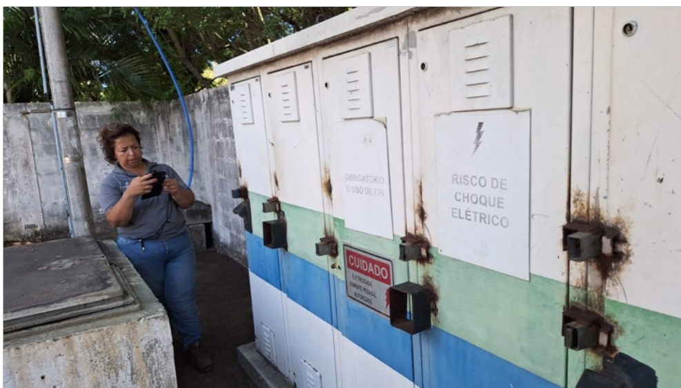
Fotos 5 – Abrigo do quadro elétrico.
