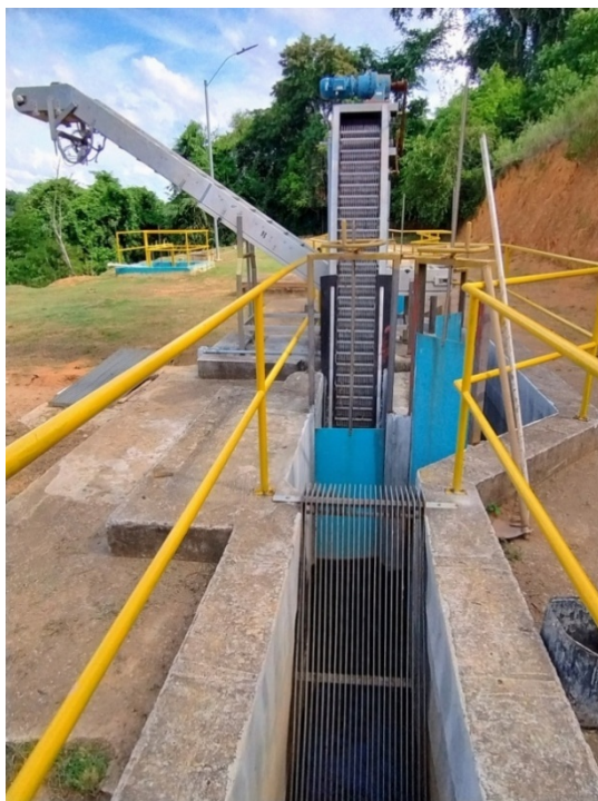
Foto 04: Chegada do esgoto bruto e gradeamento de sólidos grosseiros.
