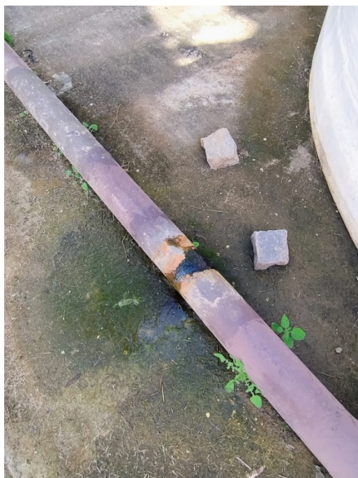
Foto 21: Vazamento na tubulação do reator.
