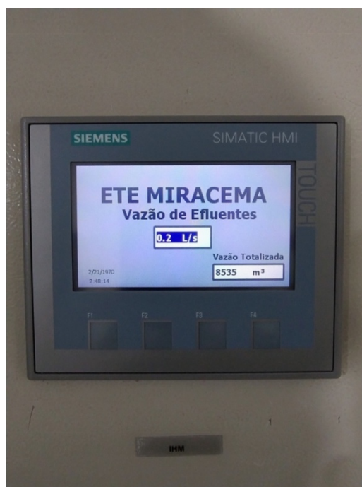
Foto 23: Painel de vazão da unidade.
