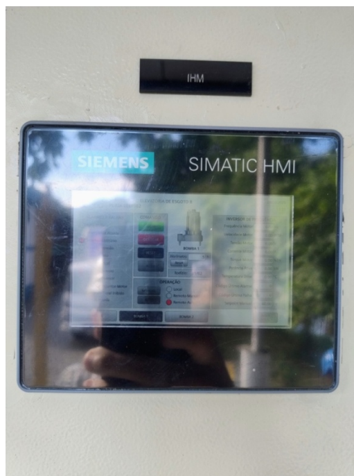
Foto 37: Tela de funcionamento da elevatória
