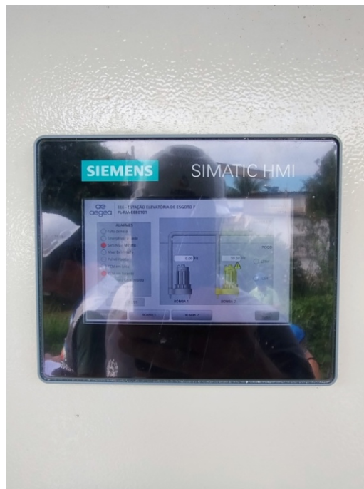
Foto 28: Tela de funcionamento da elevatória
