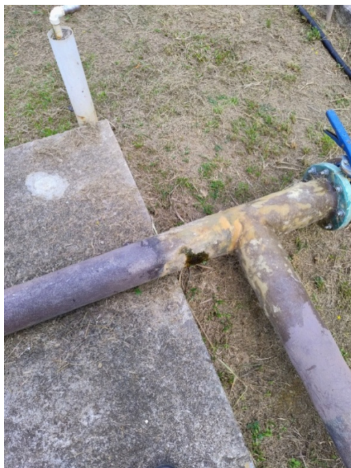
Foto 22: Vazamento na tubulação do reator.
