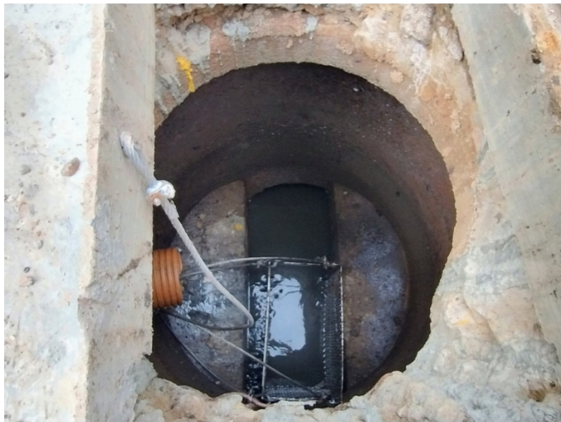
Foto 31: Gradeamento na entrada do esgoto
