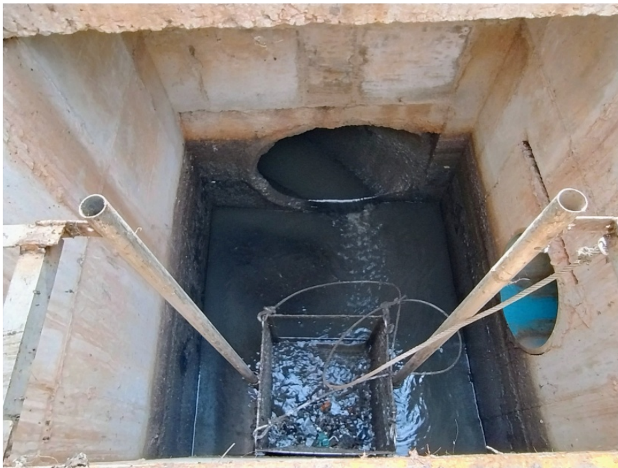
Foto 26: Gradeamento na entrada do esgoto
