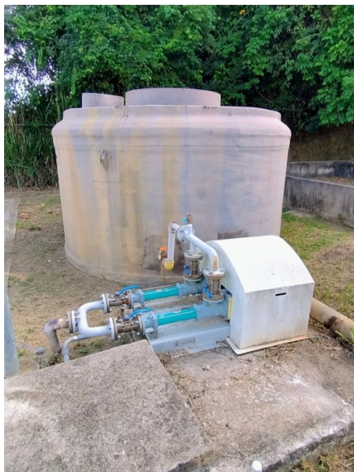
Foto 10: Elevatória de excesso de lodo.
