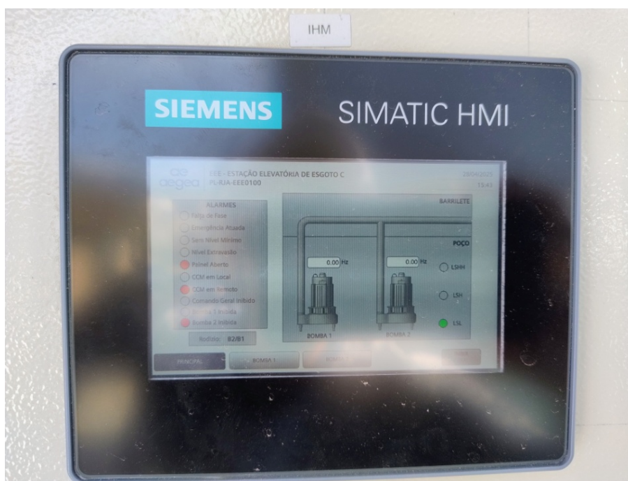
Foto 33: Tela de funcionamento da elevatória
