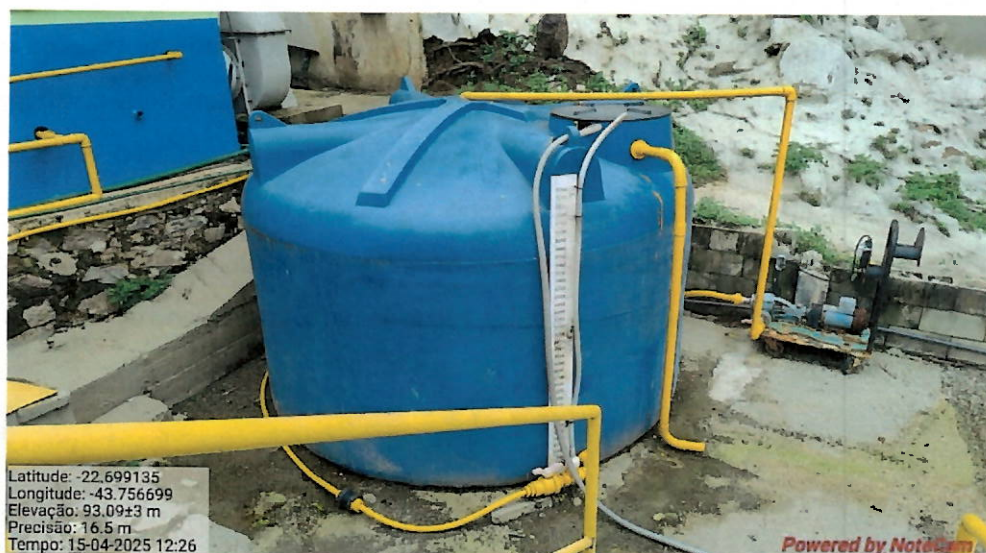
Foto 24: Tanque de armazenamento de Ortopolifosfato de Sódio.
