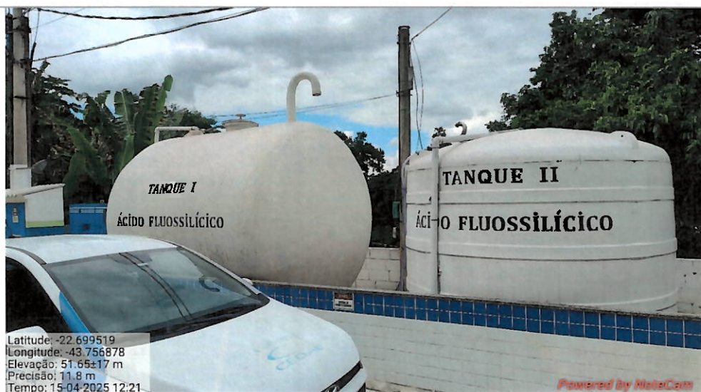
Foto 19: Tanque de armazenamento de Ácido Fluossilícico.
