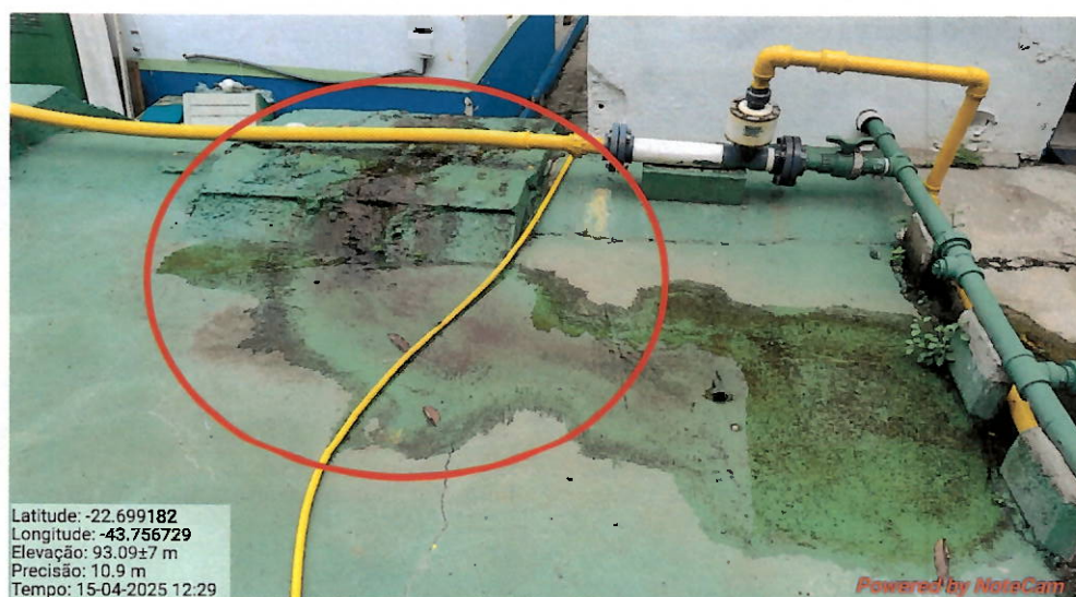
Foto 18: Vazamento de água na estrutura de concreto.
