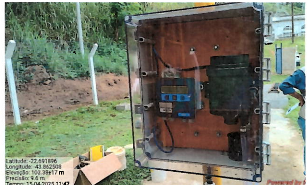
Foto 6: Turbidímetro em processo de instalação.
