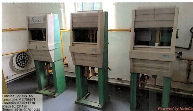
Foto 15: Dosadores de cloro.
