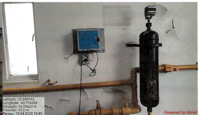
Foto 16: Aparelho detector de vazamento de cloro.
