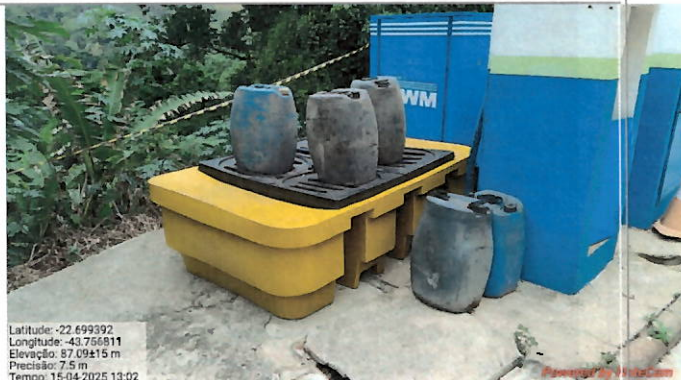
Foto 33: bacia de contenção para bombonas de combustível.
