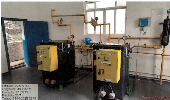
Foto 13: Evaporadores de cloro.
