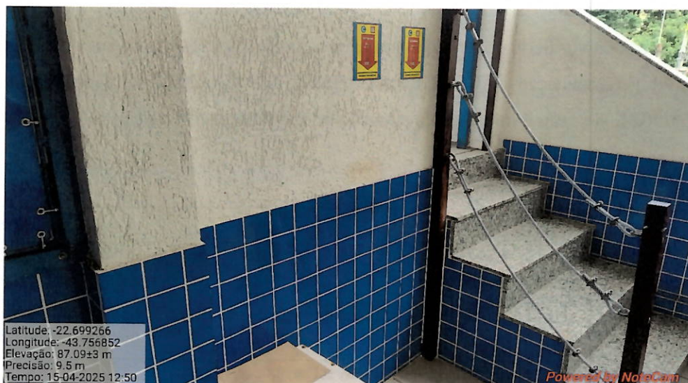
Foto 31: Ausência de extintores de incêndio.
