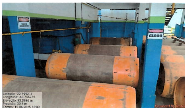
Foto 21: Cilindros de armazenamento de cloro (900 kg cada).
