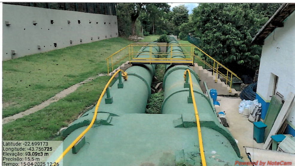
Foto 17: Ponto de injeção de cloro nas adutoras de 1750 mm.
