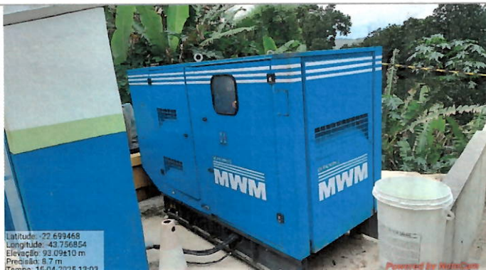
Foto 32: Gerador de energia.
