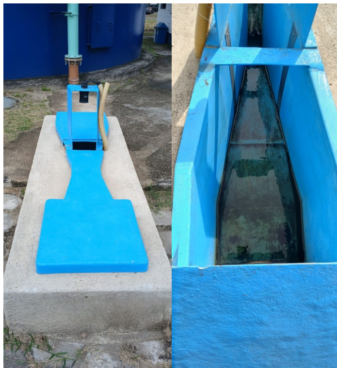
Fotos 11 e 12 – Visualização da saída do efluente clarificado da ETE na Calha Parshall
