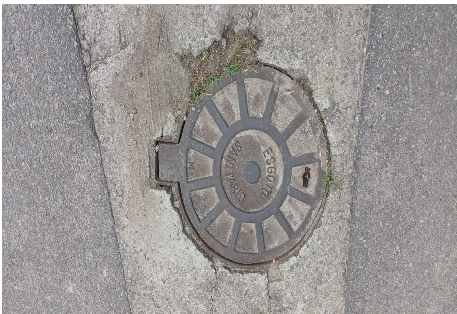
Foto 6 – Poço de visita na entrada da ETE
