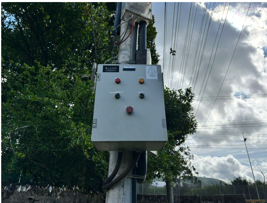
Foto 4 – Pannel de automação com sinalização de risco
