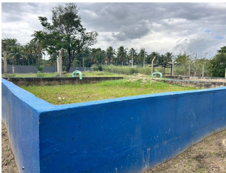
Foto 13 – Leitos de secagem do lodo proveniente do tratamento
