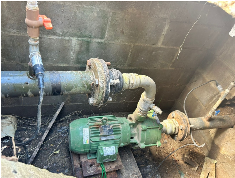
Foto 2 – Visualização interna da unidade e do conjunto motobomba
