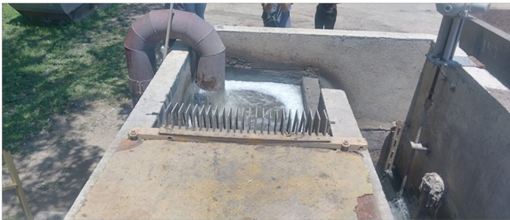
Foto 4 - Entrada do recalque de esgoto bruto; gradeamento grosso posterior.
