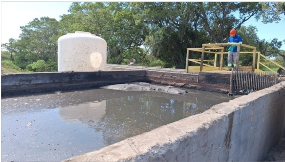
Foto 3 – Chegada dos caminhões limpa-fossa ao desarenador.
