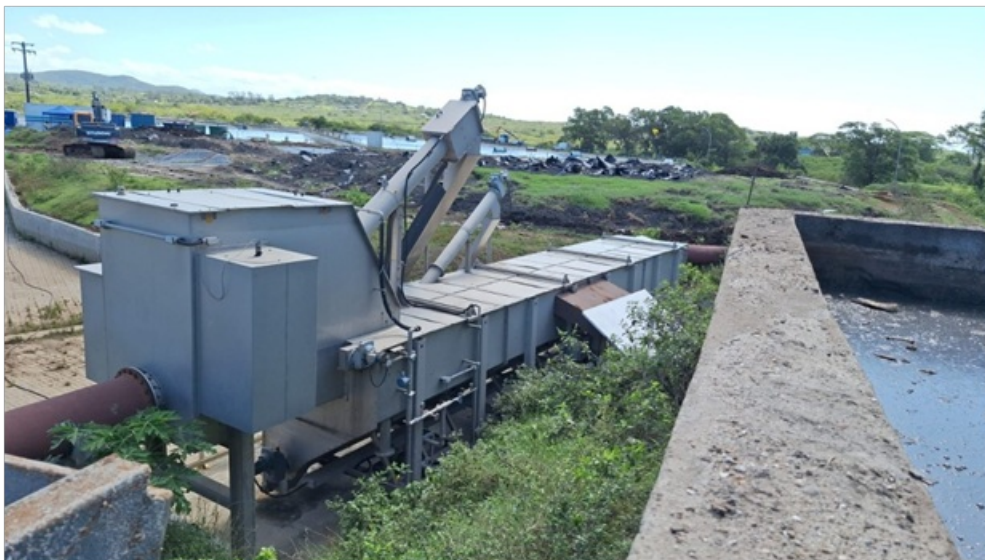
Foto 6 – Módulo de tratamento preliminar, ainda fora de operação, será relocado.
