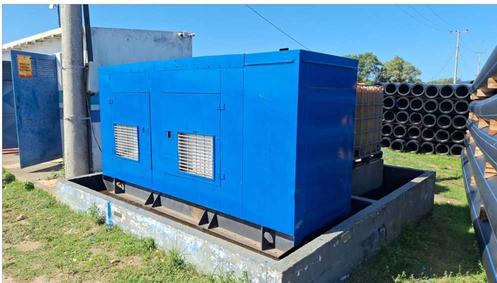
Foto 13 – Gerador com baia de contenção para óleo diesel, ao lado dos quadros elétricos.
