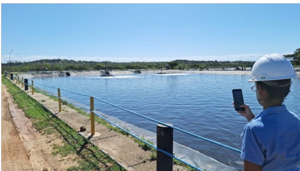
Foto 8 – Tanque de aerção só com dois aeradores e cerca de proteção danificada, provavelmente para a retirada de aeradores para manutenção
