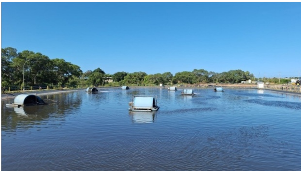
Foto 9 – Tanque de aeração com 7 aeradores e só 4 em operação.
