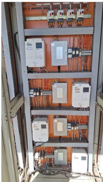
Foto 12 – Um dos quadros elétricos onde há diversos inversores de frequência como este que tem 4 unidades, para correspondentes aeradores.
