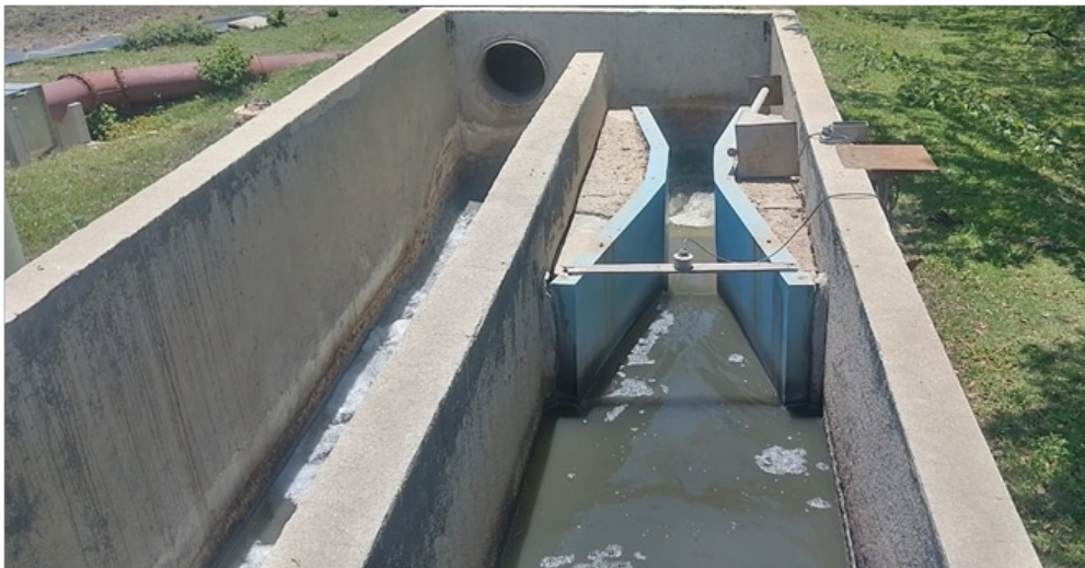
Foto 5 – Medidor de vazão tipo calha Parshall com sensor para medição por telemetria
