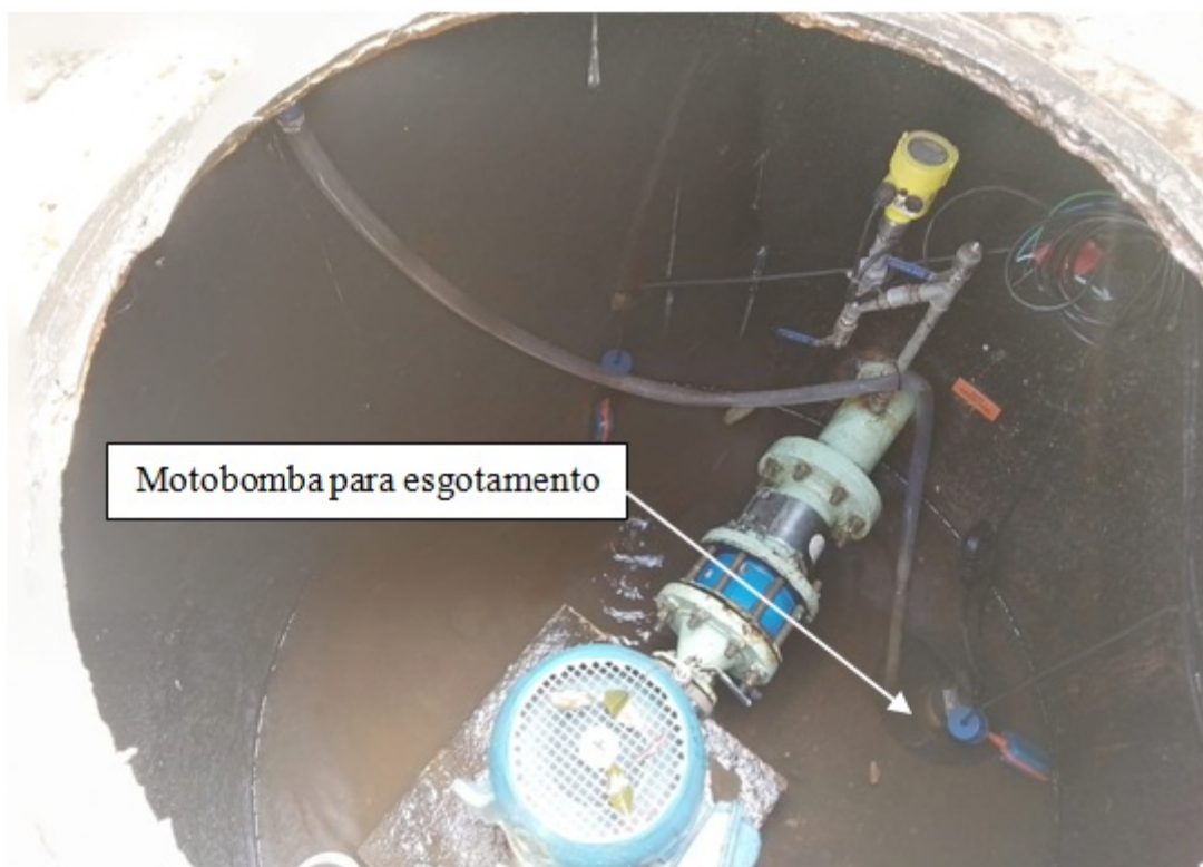
Foto 13 – Água no interior do “panelão” e esgotamento mecânico
