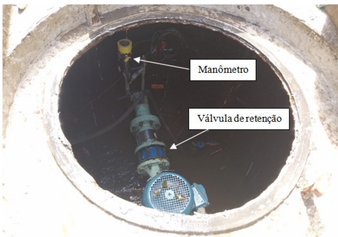
Foto 12 – Válvula de retenção e manômetro
