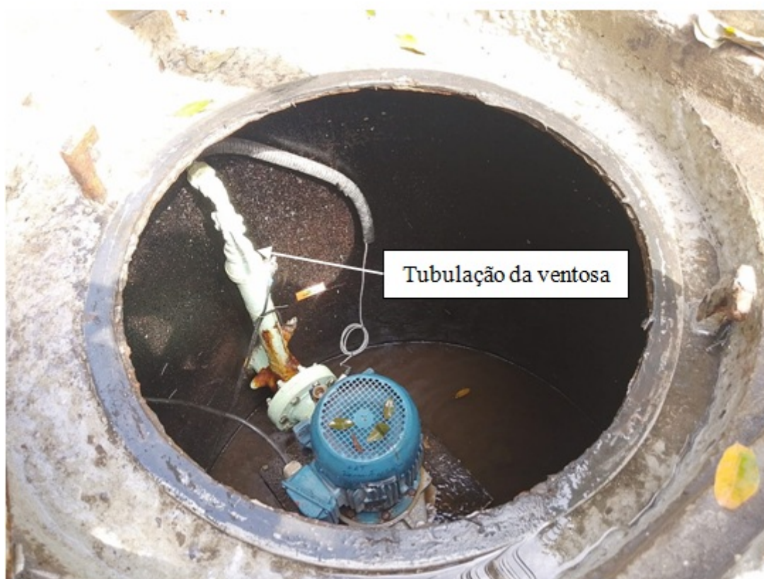
Foto 16 – Tubulação da ventosa
