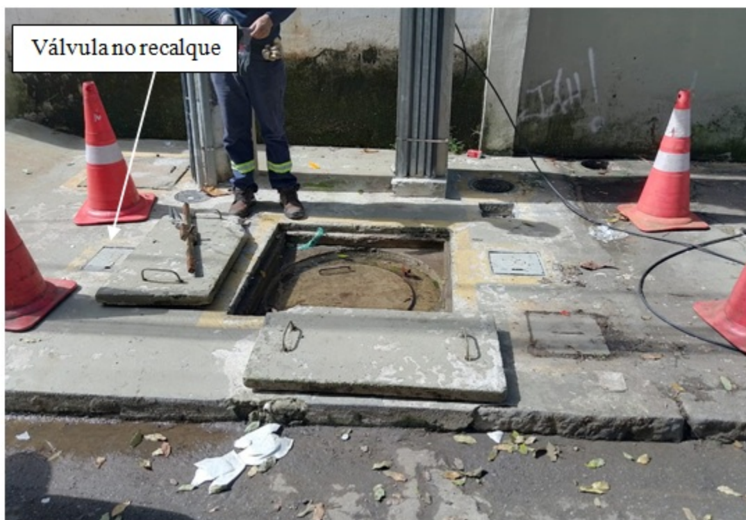
Foto 9 – Válvula na tubulação de recalque
