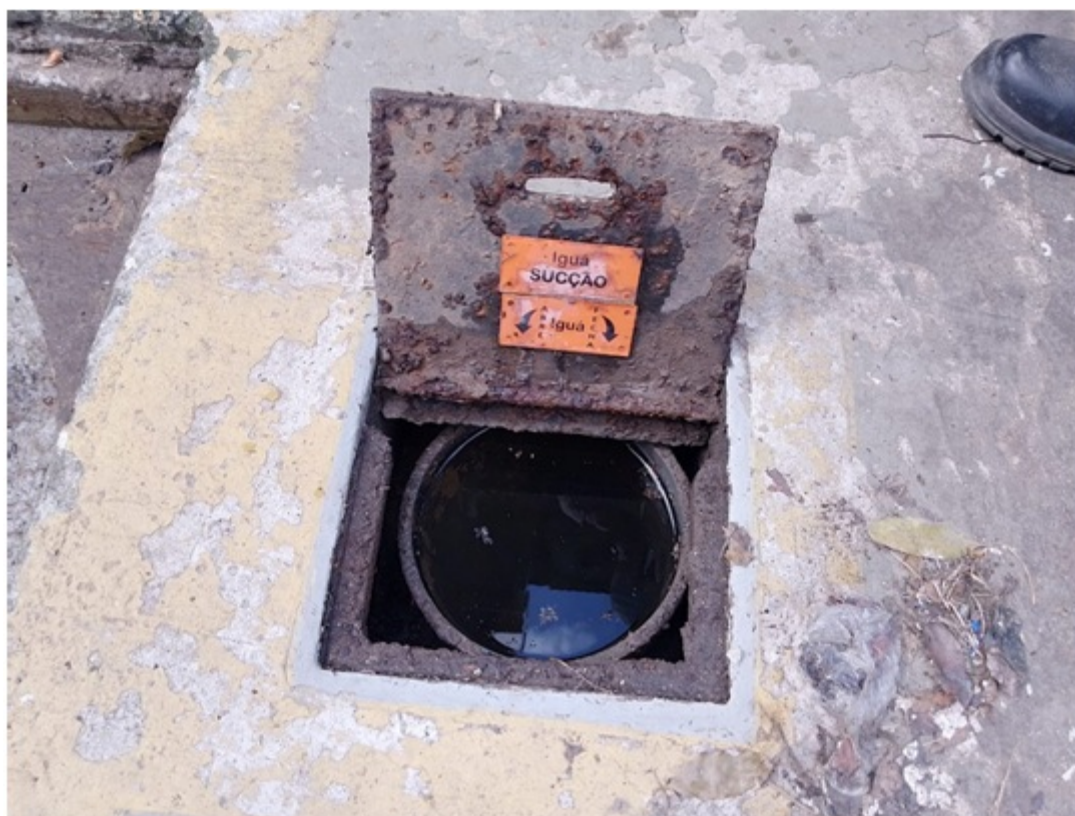
Foto 8 – Válvula na tubulação de sucção
