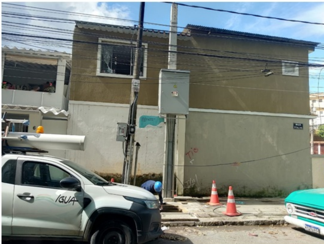
Foto 19 – Vista frontal da EEAT Italva
