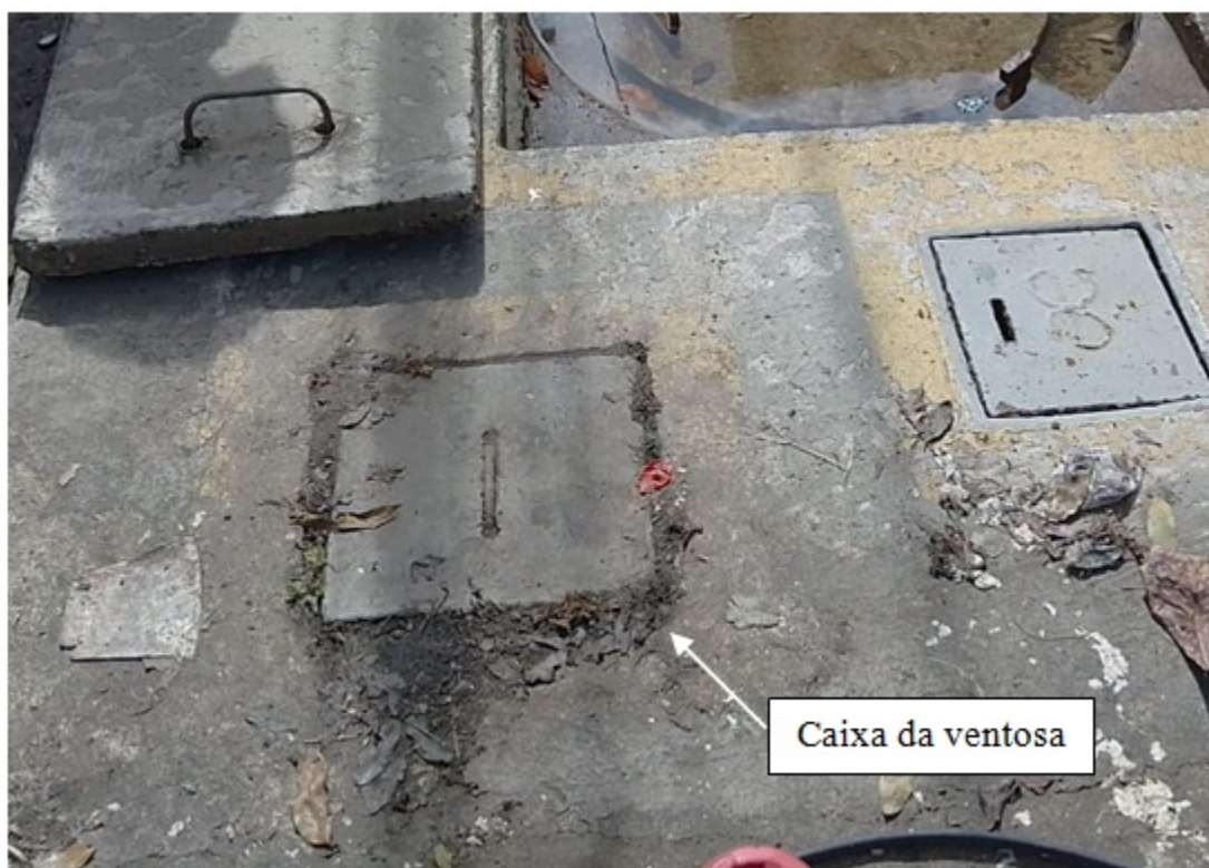
Foto 14 – Caixa onde está instalada a ventosa
