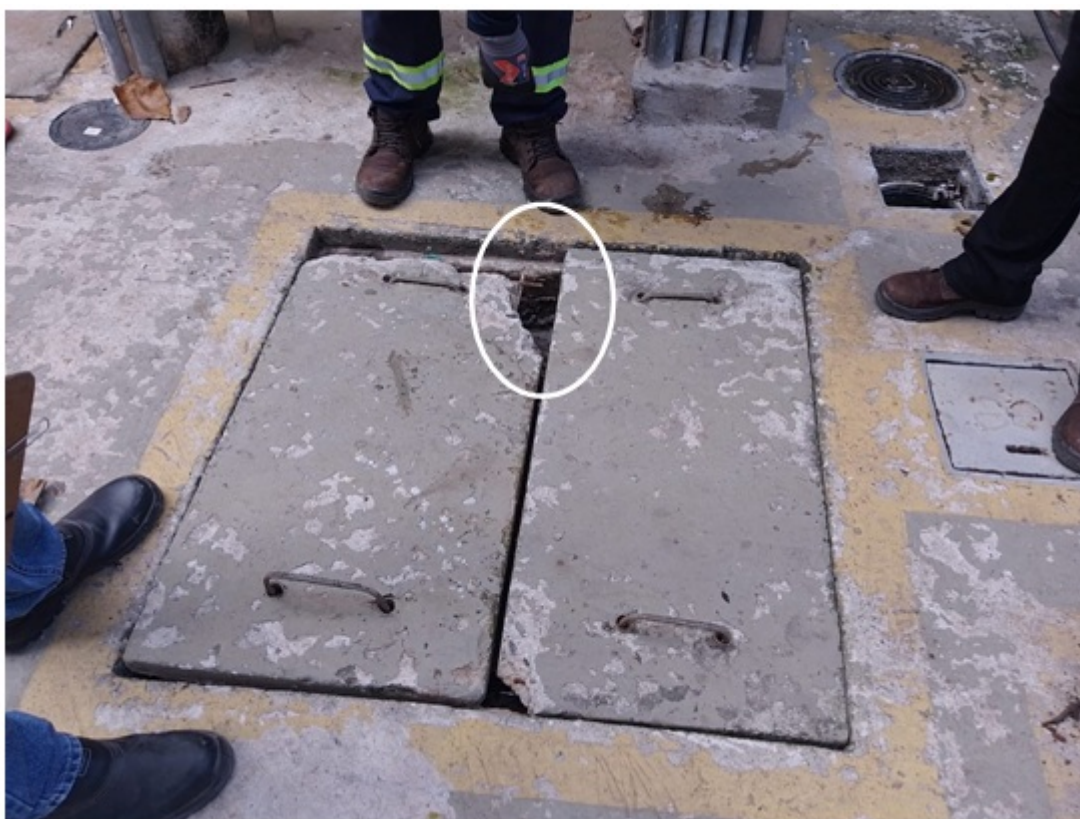
Foto 6 – Tampa de concreto do abrigo quebrada em uma das extremidades
