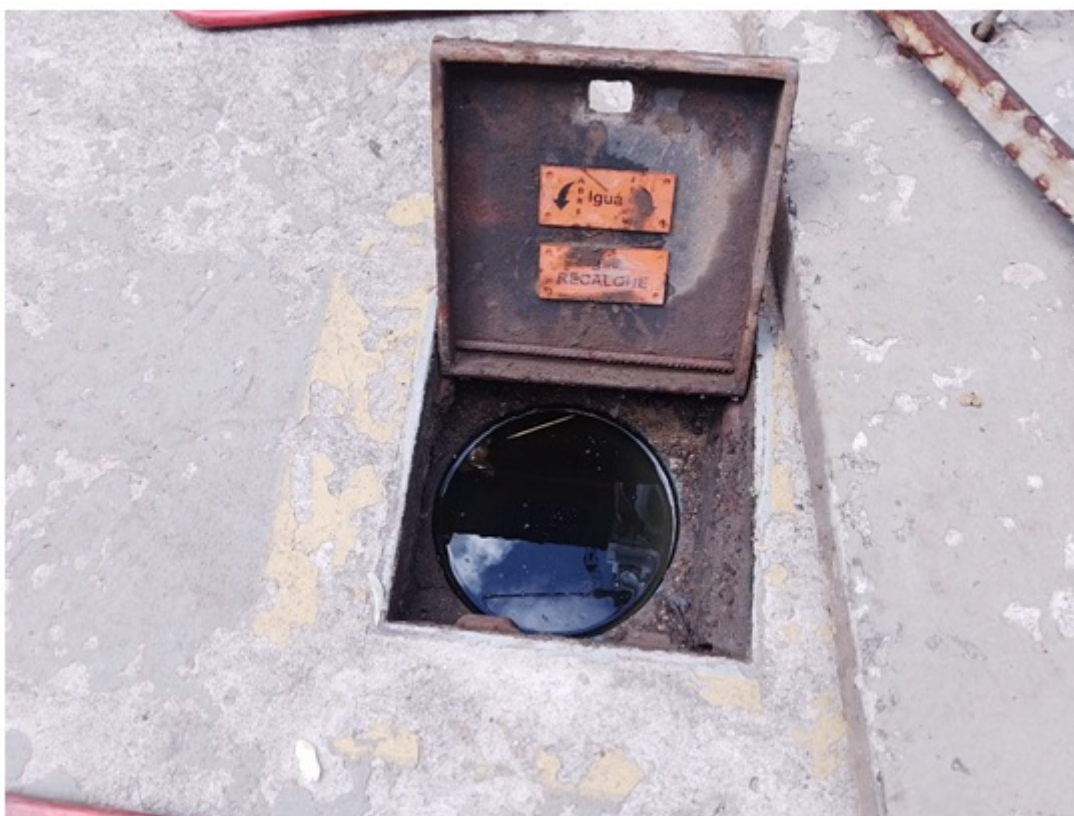
Foto 10 – Válvula na tubulação de recalque
