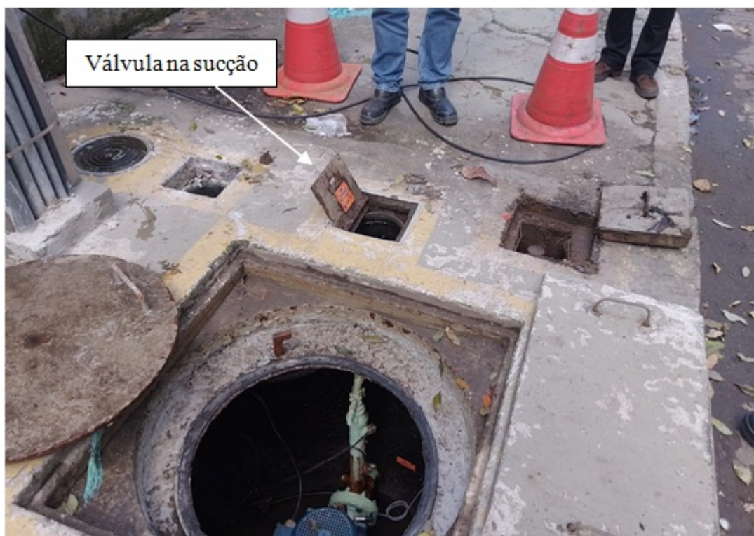
Foto 7 – Válvula na tubulação de sucção
