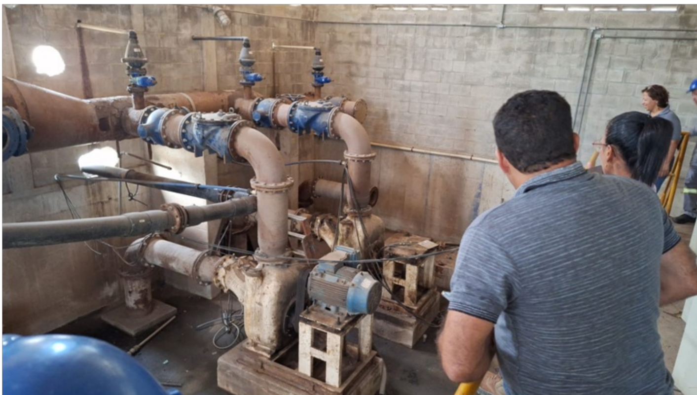
Fotos 6 – Vista da Montagem eletromecânica da EEE, onde só operava um conjunto moto-bomba.
