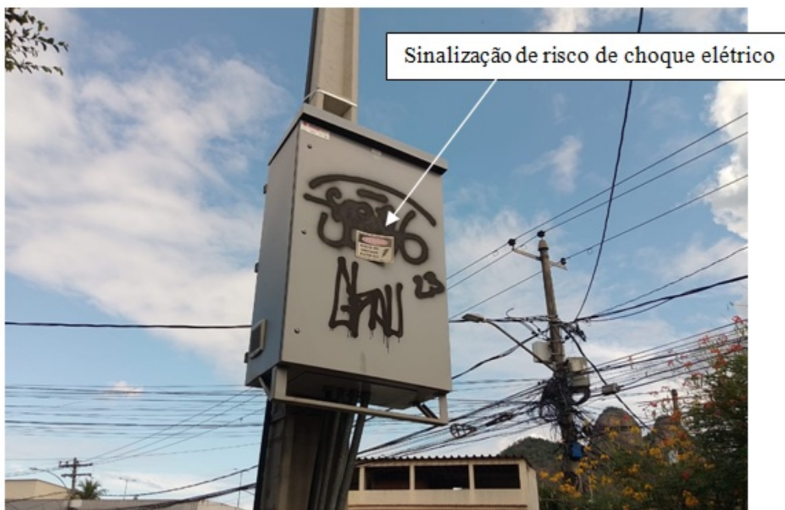
Foto 9 – Cabine do painel elétrico com sinalização de choque elétrico
