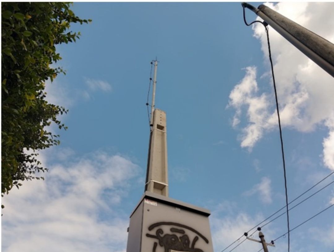
Foto 11 – Para-raios instalado no poste
