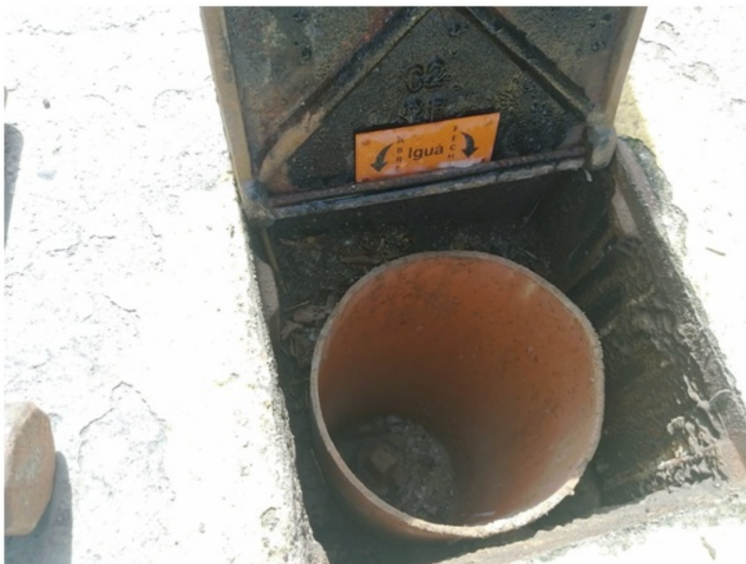
Foto 12 – Válvula na tubulação de sucção
