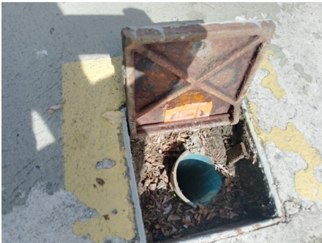
Foto 13 – Válvula na tubulação de recalque
