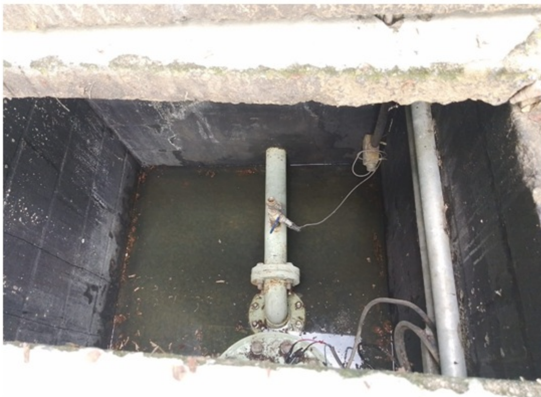
Foto 8 – Água no interior do abrigo
