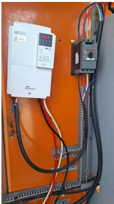
Foto 3 – Quadro elétrico com inversor de frequência, proteção e telemetria.
