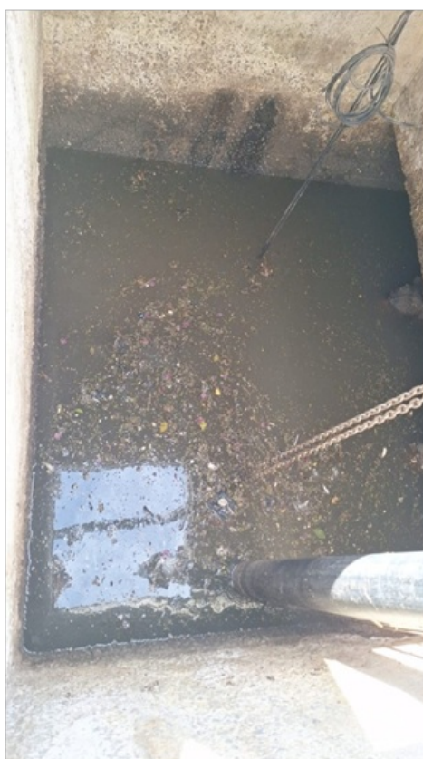
Foto 4 – Poço da EEE com uma bomba submersível e controle de nível com aut-bóia.
