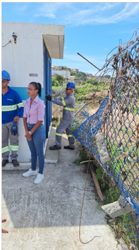
Foto 5 – Cerca danificada por vandalismo.
