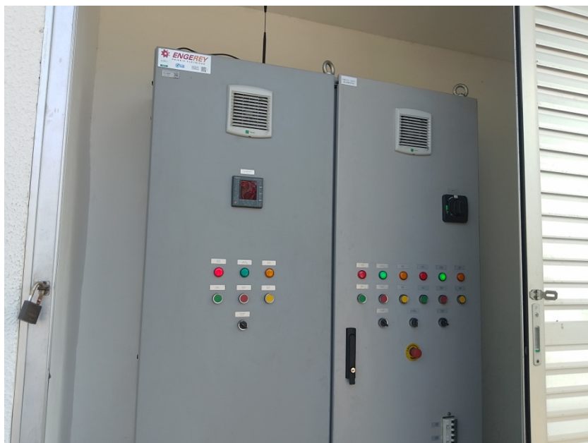
Foto 4 – Painele de controle
