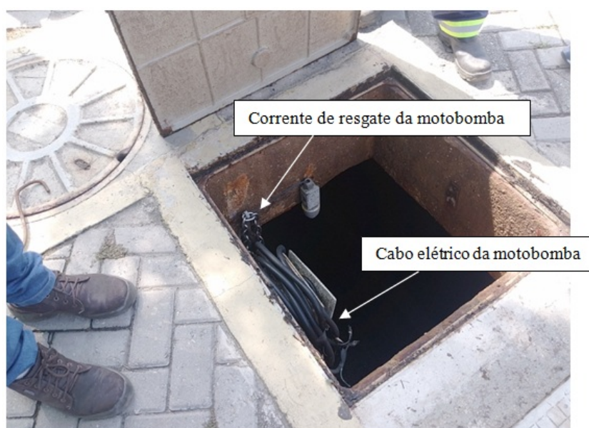
Foto 12 – Visita onde está uma das motobombas submersíveis
