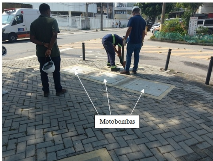
Foto 11 – Cada motobomba fica instalada em uma visita
