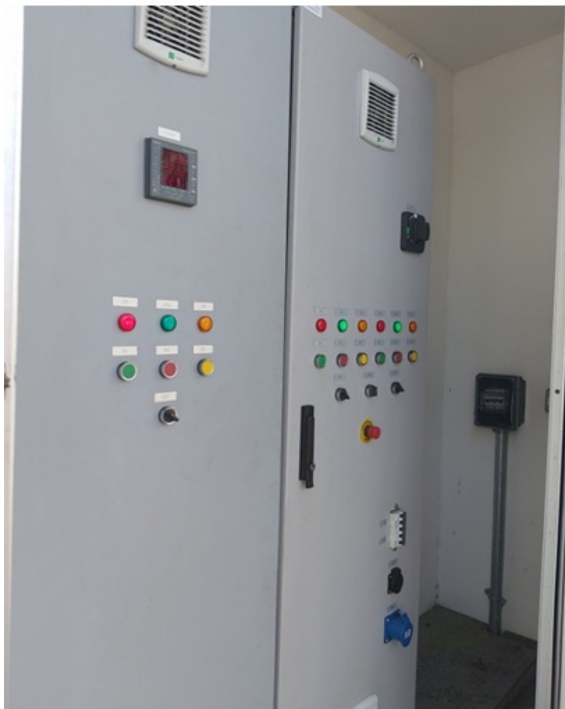
Foto 5 – Painel de controle
