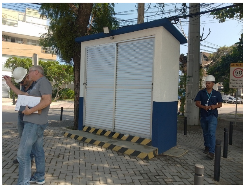
Foto 6 – Ausência de sinalização de risco de choque elétrico
