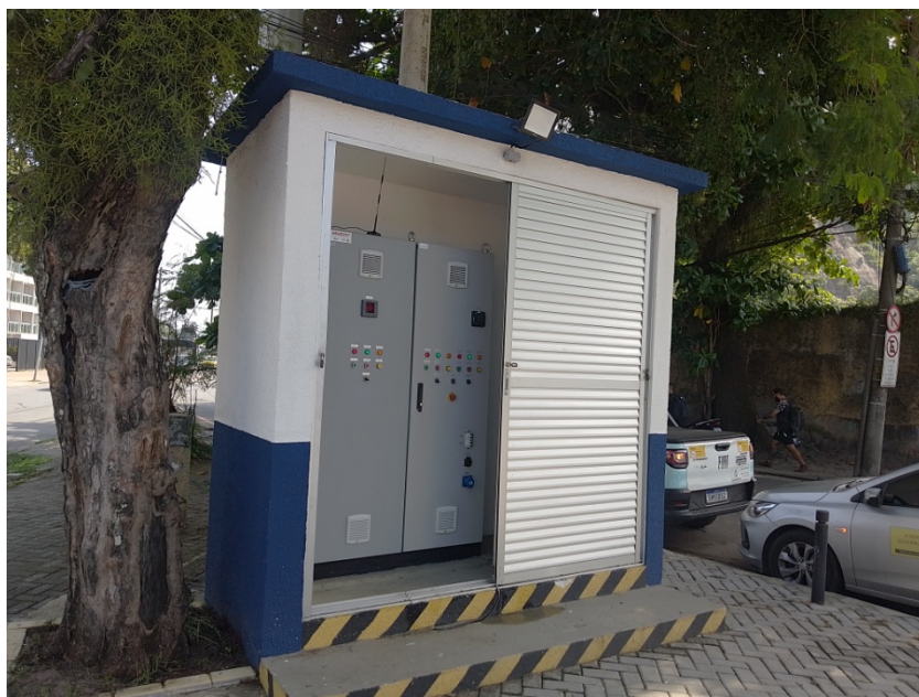
Foto 2 – Painel da EEAB no abrigo
