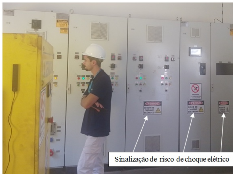
Foto 6 – Sinalização de risco de choque elétrico
