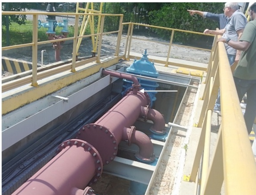
Foto 24 – Tubulação da ventosa - Barrilete com 2 conjuntos motobomba
