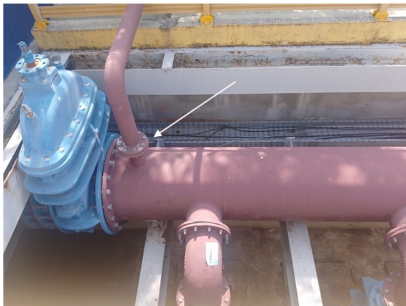
Foto 23 – Tubulação da ventosa - Barrilete com 3 conjuntos motobomba
