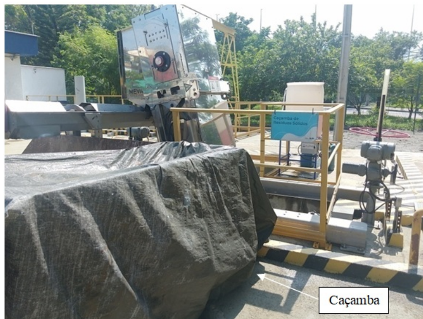
Foto 14 – Caçamba ao lado do gradeamento mecânico
