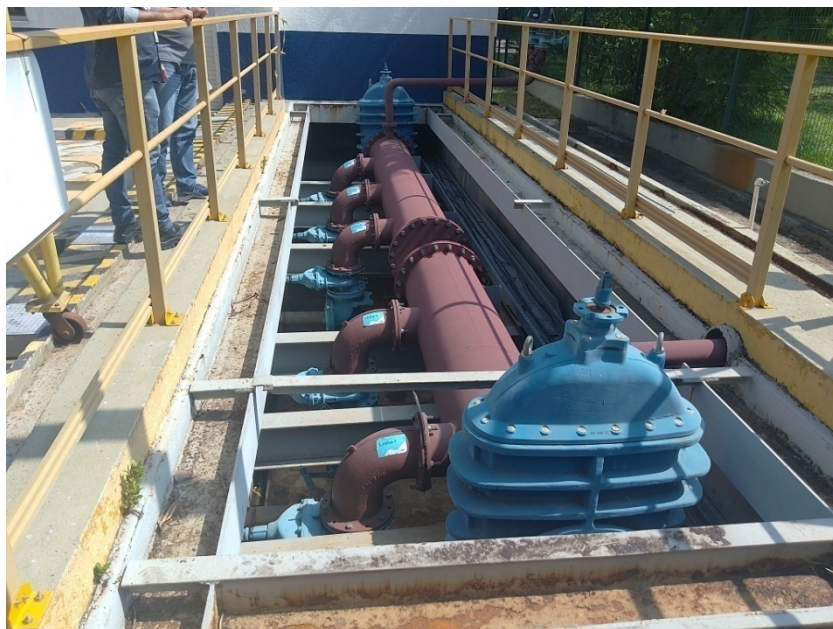
Foto 22 – Barriletes do recalque com válvulas de fechamento
