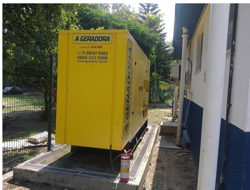
Foto 7 – Gerador e bacia de contenção
