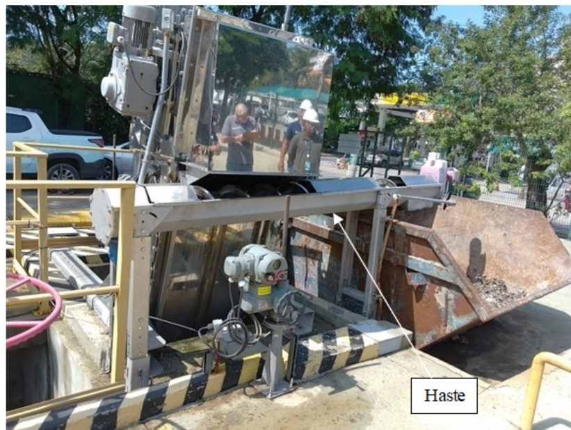
Foto 16 – Haste que encaminha os resíduos sólidos para a caçamba
