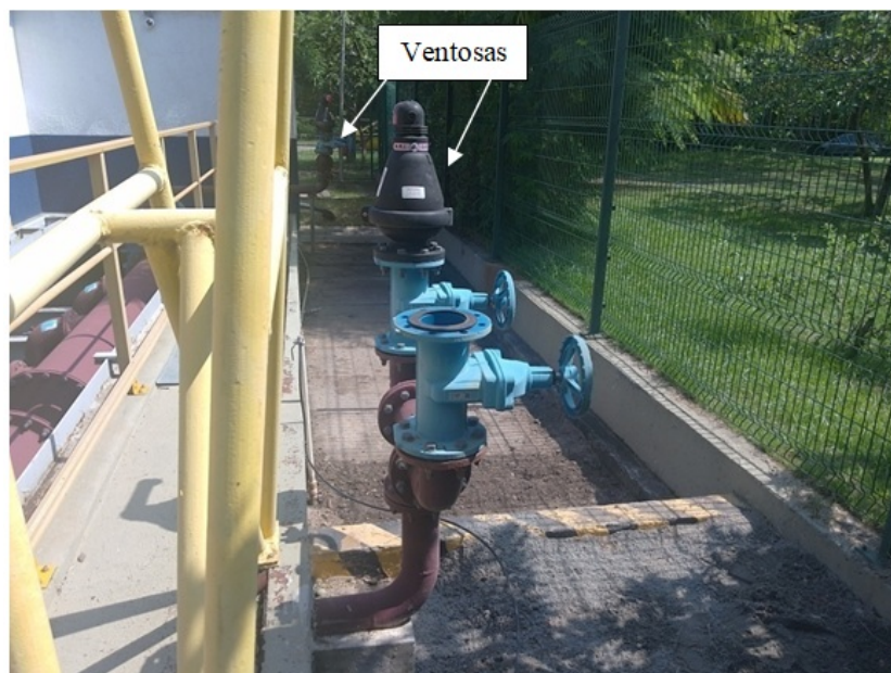
Foto 25 – Ventosas instaladas em cada tubulação
