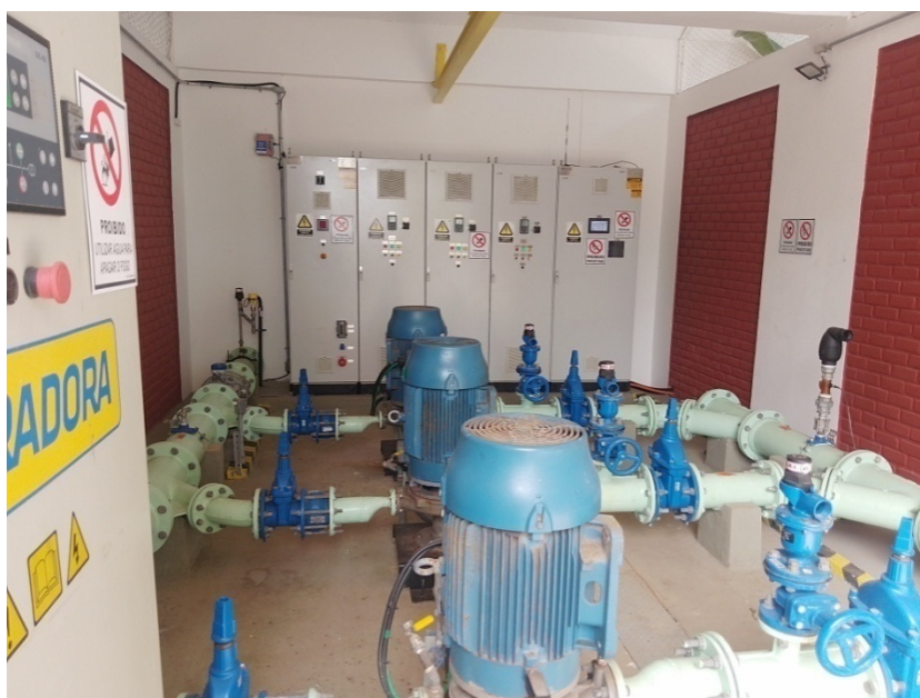
Foto 10 – Válvulas de fechamento, retenção e derivações no recalque de DN 100 mm
