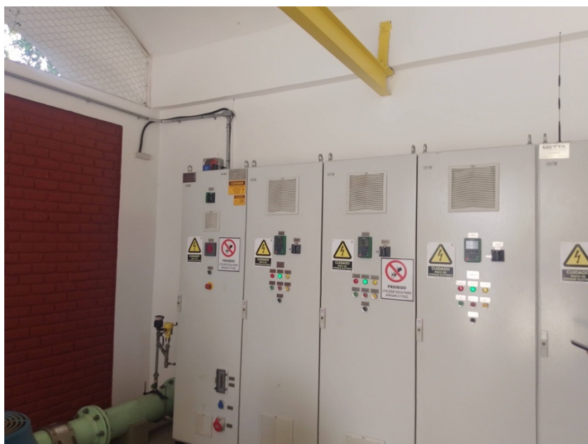
Foto 16 – Painéis elétricos com sinalização de risco de choque elétrico
