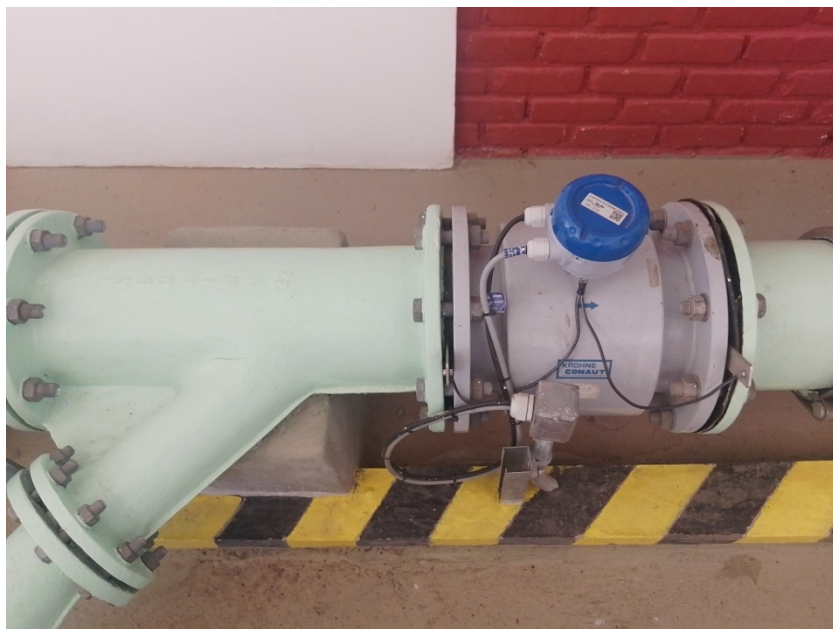
Foto 13 – Medidor de vazão
