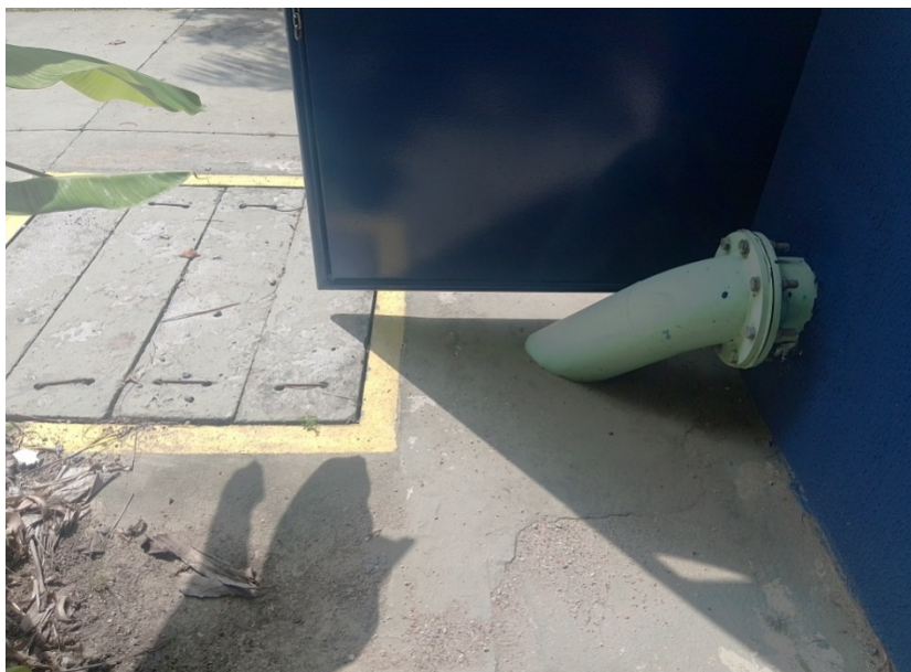
Foto 5 – Gerador e bacia de contenção
