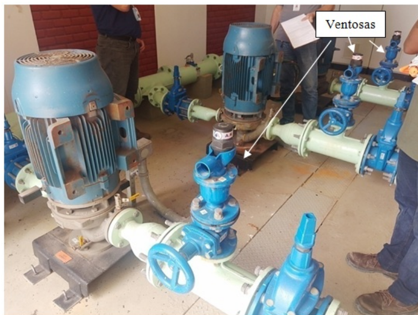
Foto 7 – Ventosa na tubulação de sucção
