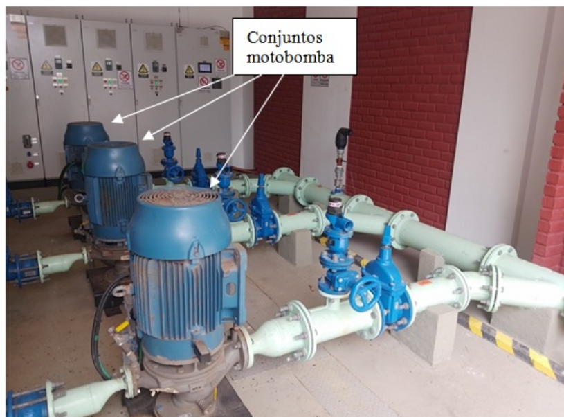
Foto 8 – Conjuntos motobomba e tubulação de sucção
