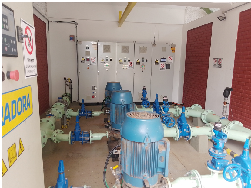
Foto 15 – Painéis elétricos com sinalização de risco de choque elétrico
