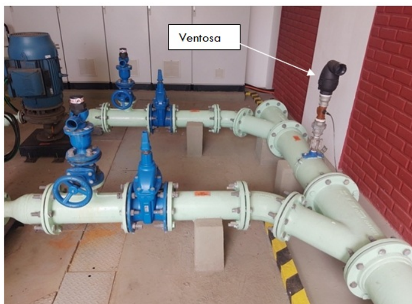
Foto 6 – Ventosa na tubulação de sucção
