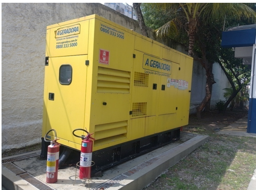
Foto 4 – Gerador e bacia de contenção
