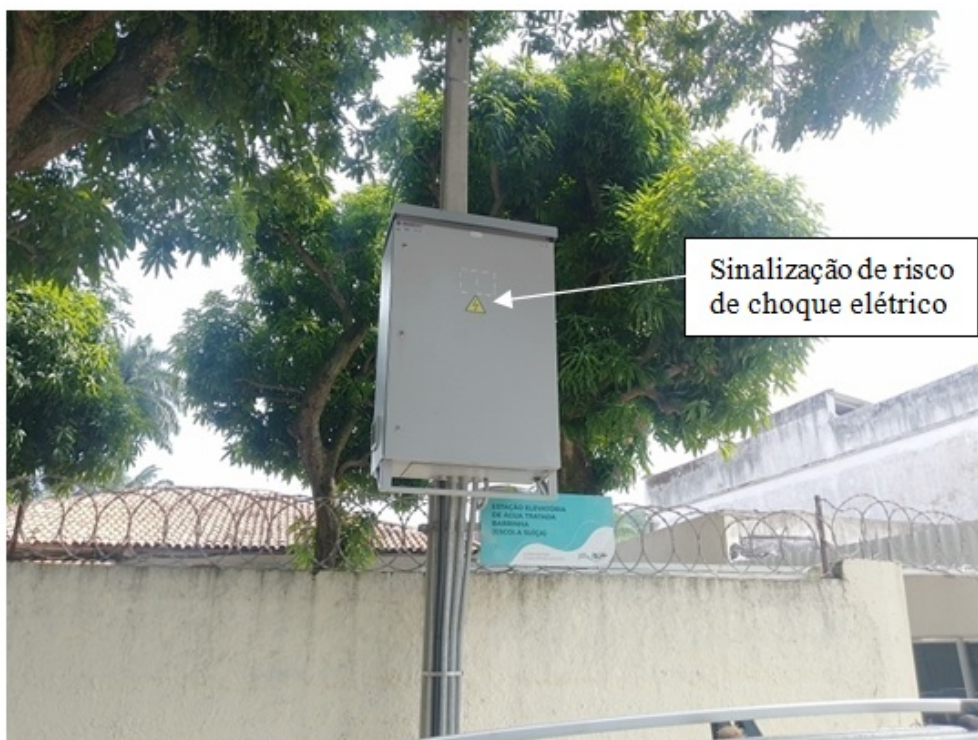
Foto 7 – Cabine do painel elétrico
