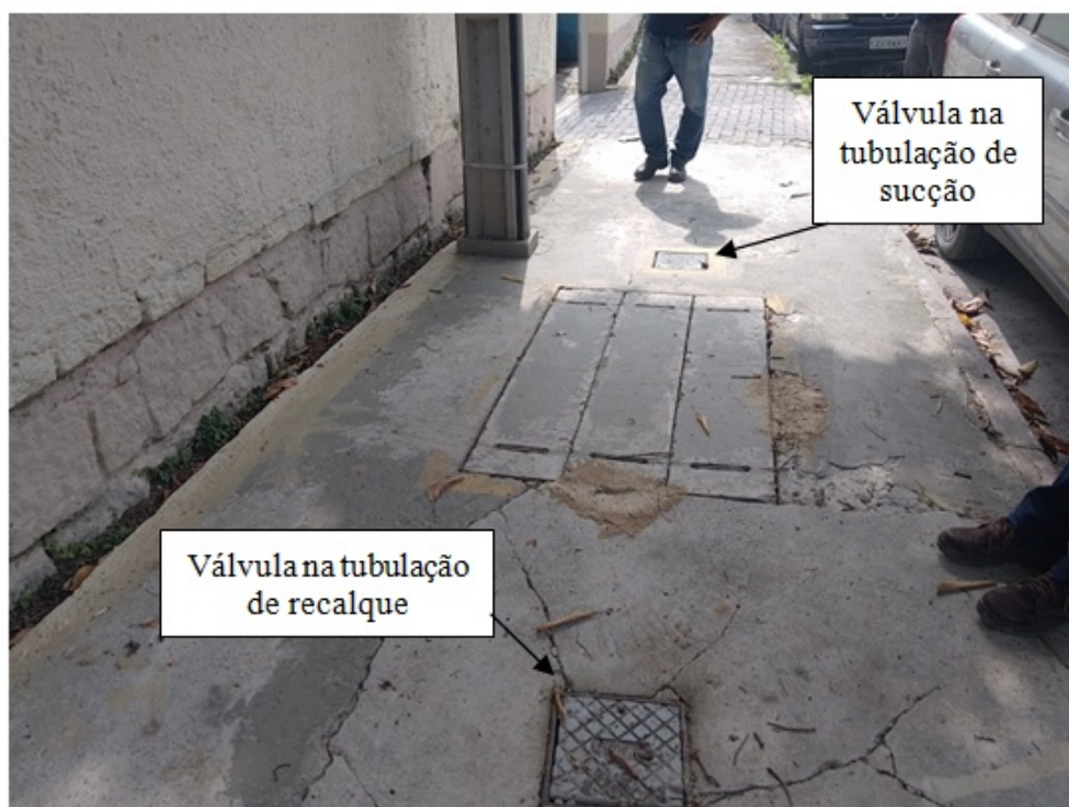
Foto 4 – Válvulas de sucção e recalque
