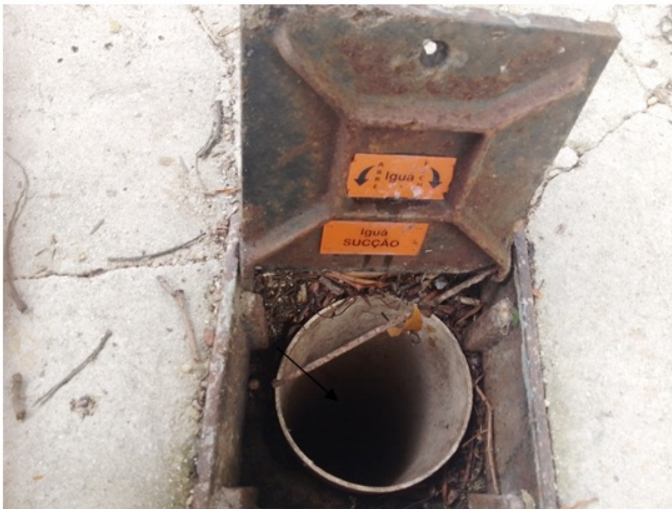
Foto 5 – Válvulas de sucção
