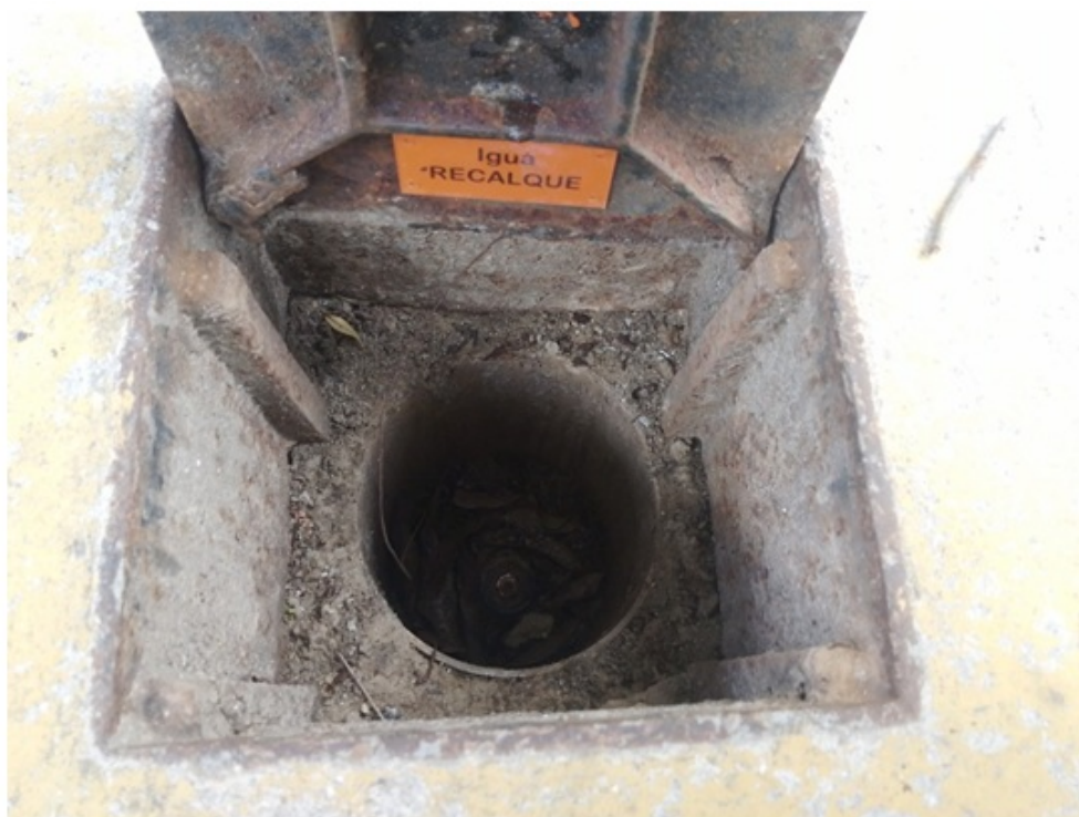
Foto 6 – Válvulas de recalque
