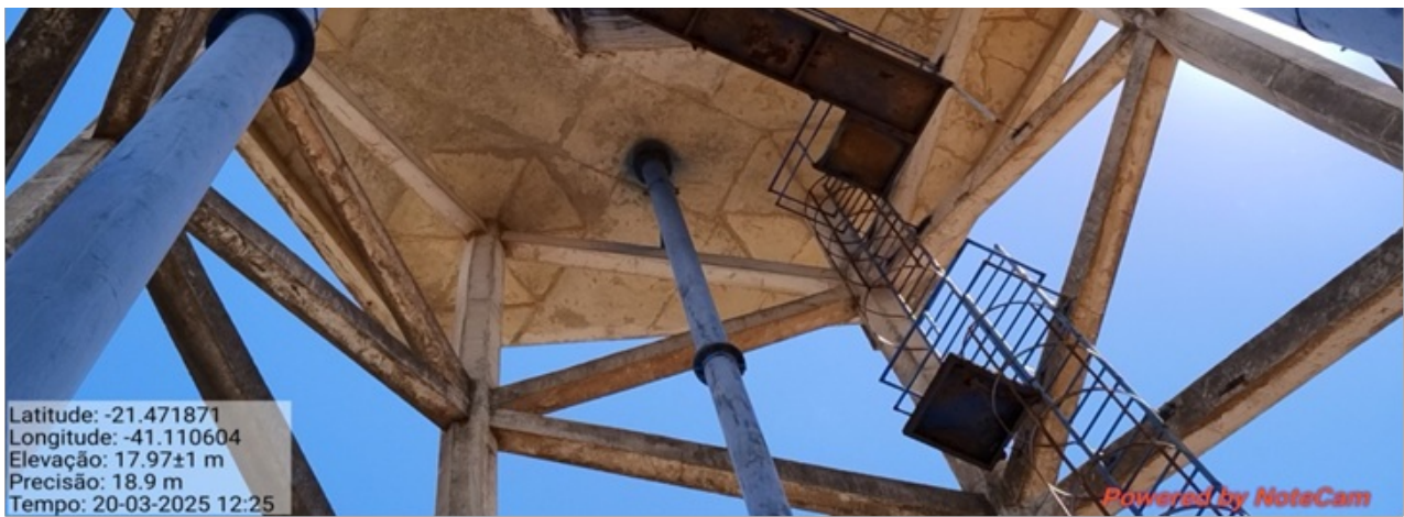
Foto 7 – Rampas de acesso ao reservatório danificado
