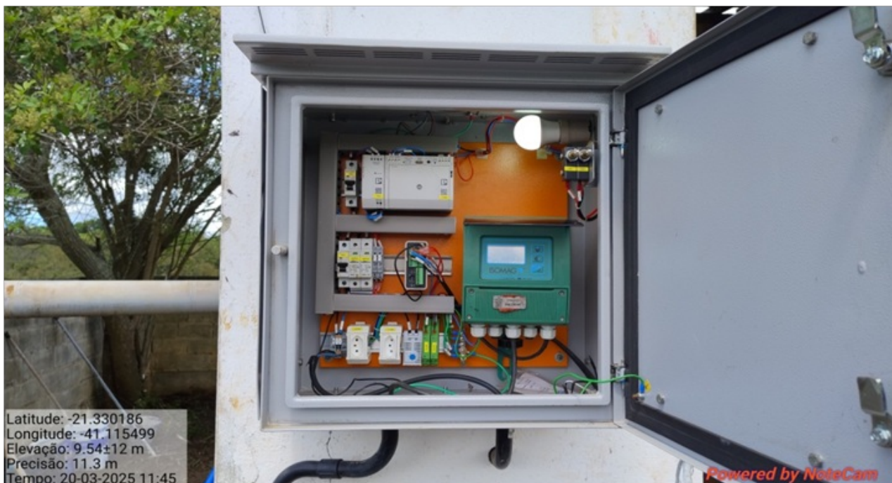
Foto 5 – Painel de automação
