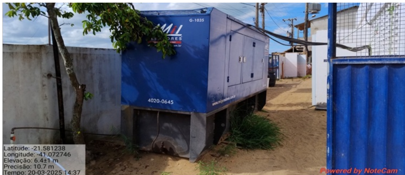
Foto 8 – Gerador de energia da unidade
