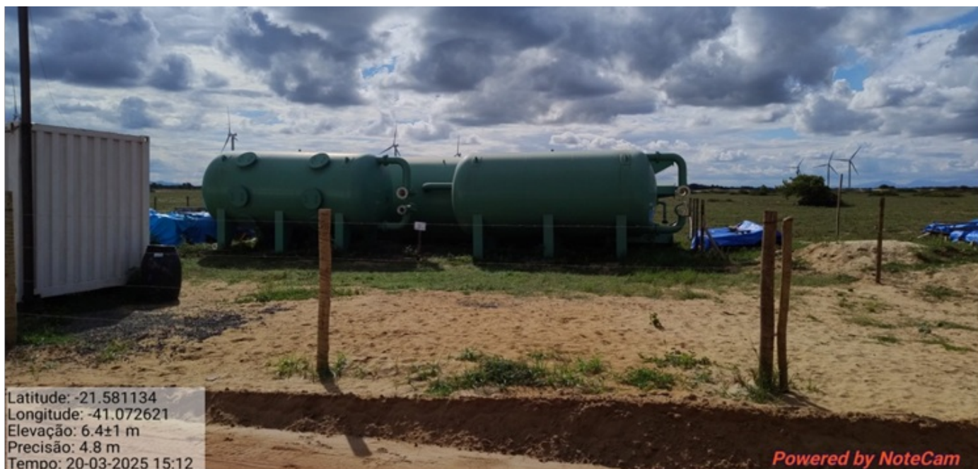
Foto 10 - Novo sistema de filtragem de água composto por filtros zeólita
