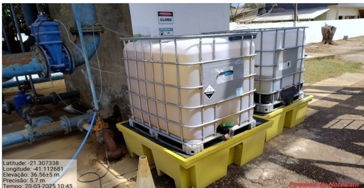
Foto 8 - sistema de armazenamento de cloro
