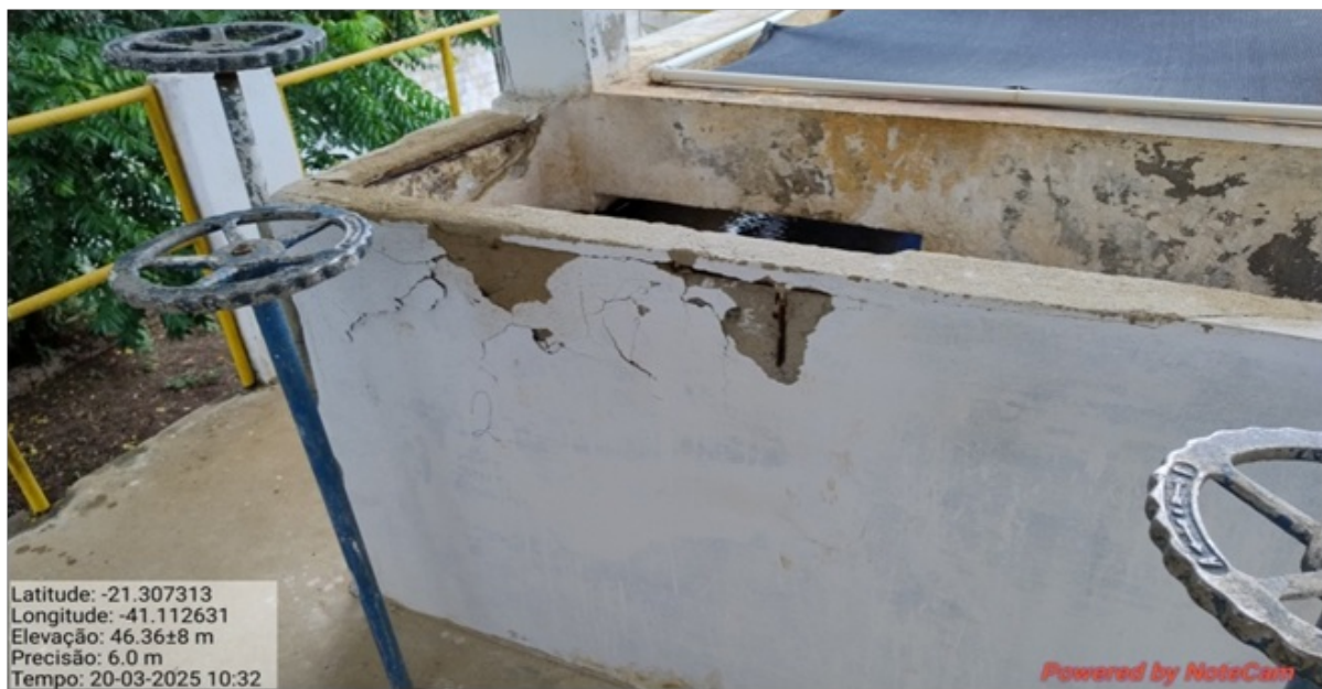
Foto 13 - deslocamento de reboco, trincas visíveis
