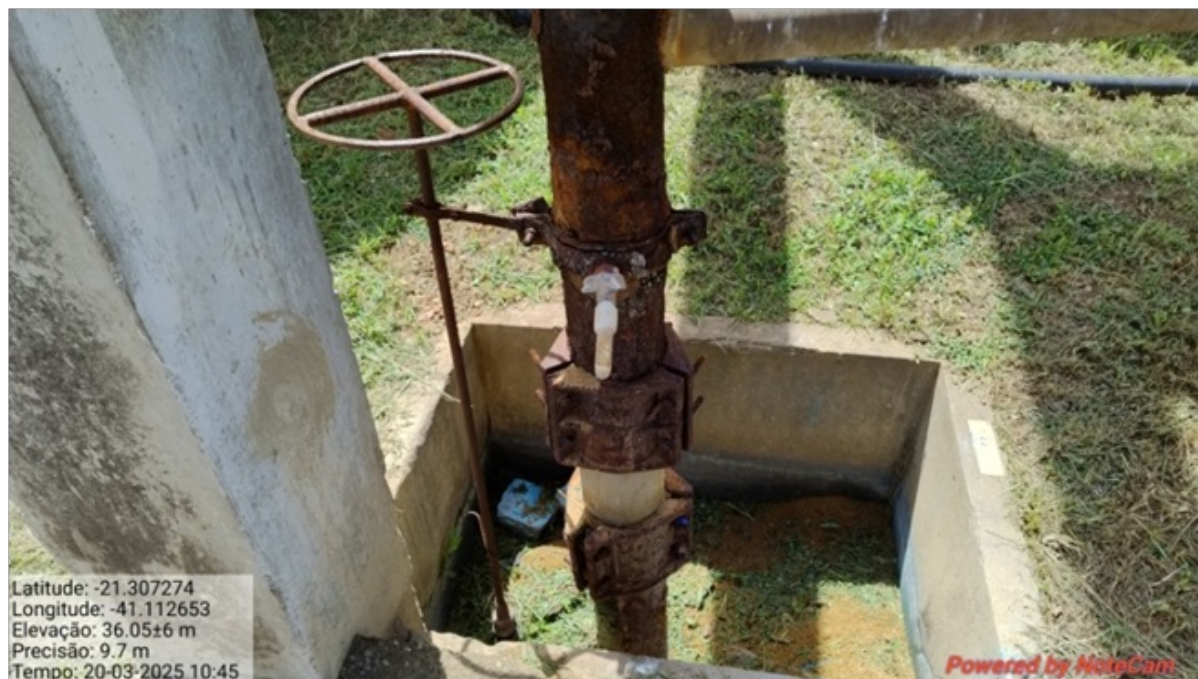
Foto 14 - registro e tubulação metálica severamente corroídos
