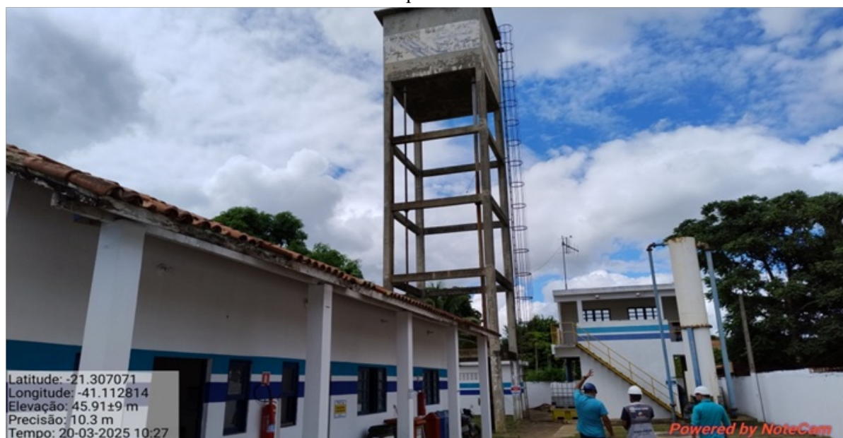
Foto 12 – Reservatório superior – 100 m 3
