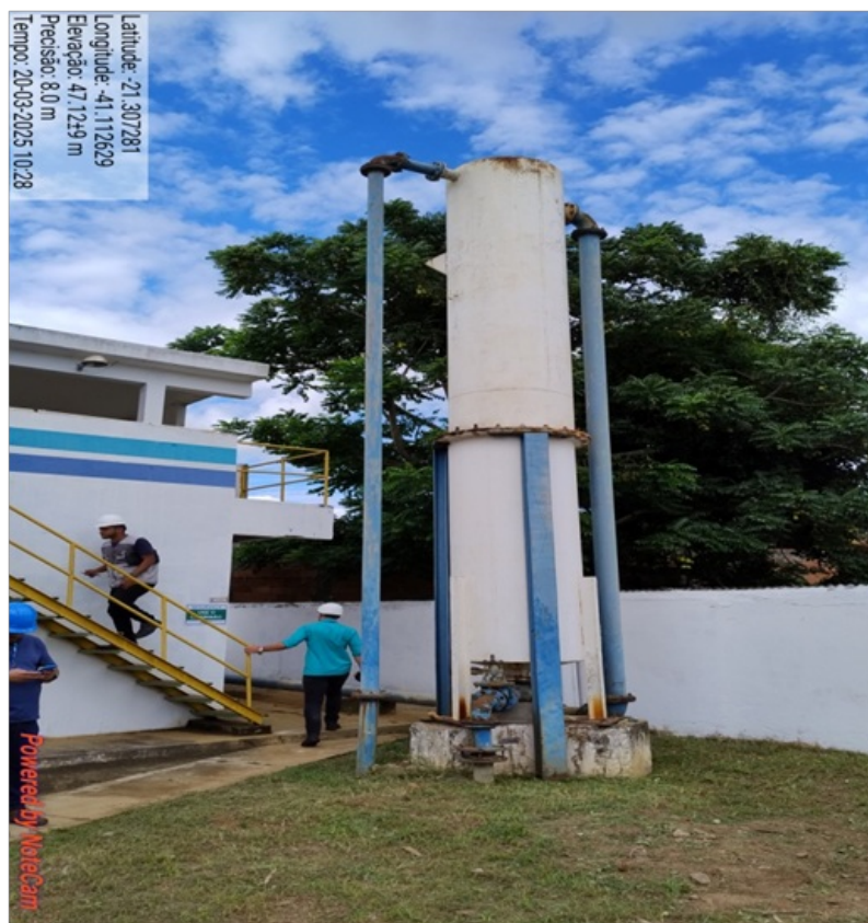
Foto 2 – floculador vertical hidráulico
