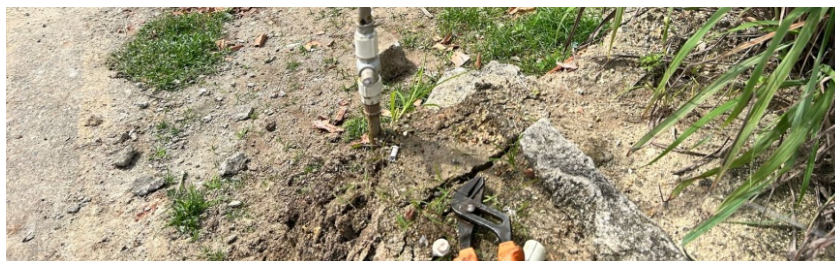
Foto 12 – Medição de pressão no ponto mais alto da rua
