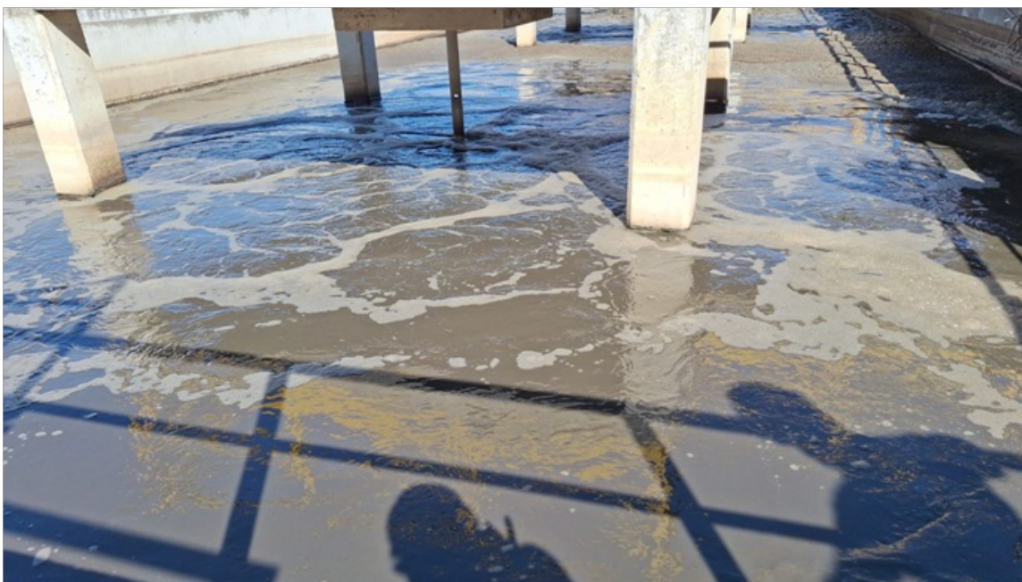
Fotos 10,11 e12 – Esgoto recalcado do preliminar; tanque anóxico onde recebe produto químico; tanque de aeração que opera com um dos aeradores mergulhado, funcionando como agitador.
