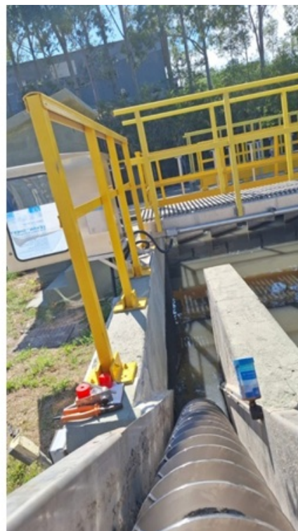
Fotos 8 e 9 – Vista do desarenador com aletas ao fundo, para quebrar turbulência e parafuso para retirarr a areia/lodo para adensamento, desidratação e descarte. Estas unidades foram reformadas junto com a nova ETE.
