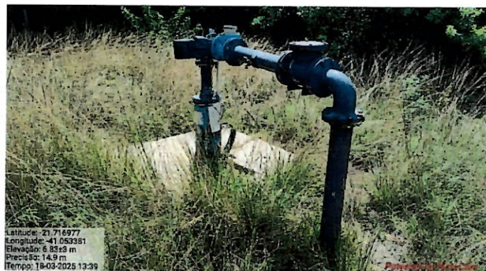
Foto 61: Poço de captação.
