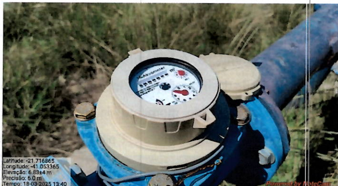
Foto 62: Medidor de vazão.
