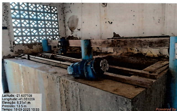
Foto 29: Tanques de diluição (ausência de bacia de contenção).
