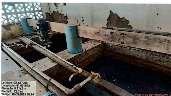
Foto 30: Tanques de diluição (1.000 litros cada).
