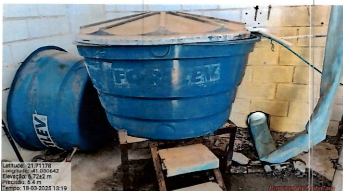
Foto 54: Sistema de tratamento.
