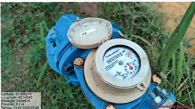
Foto 100: Medidor de vazão.
