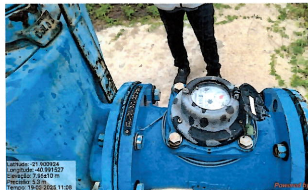
Foto 117: Medidor de vazão.
