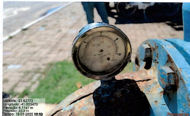
Foto 37: Medidor de pressão danificado.
