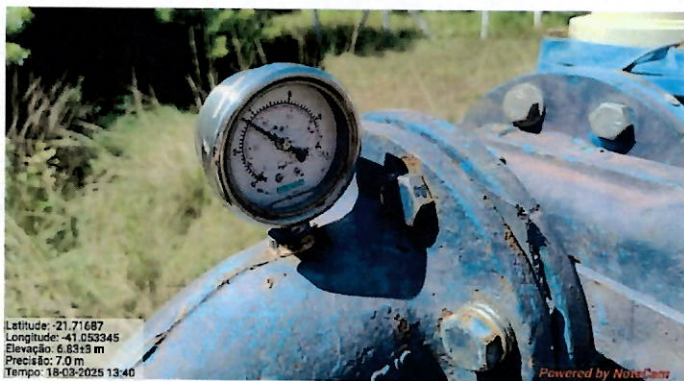
Foto 63: Medidor de pressão.
