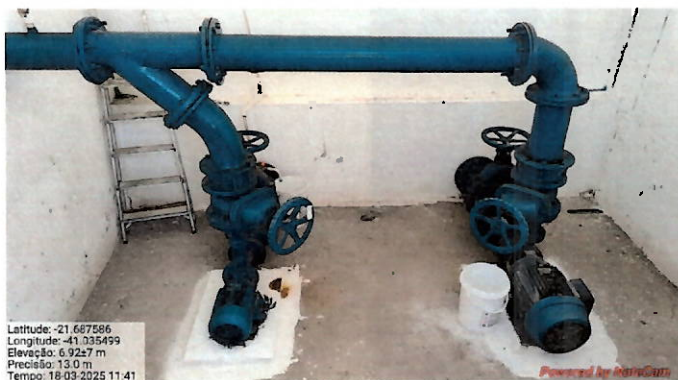
Foto 49: Conjuntos motobombas (CMB).
