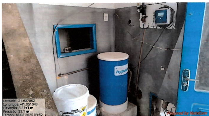
Foto 19: Sistema de cloração principal.
