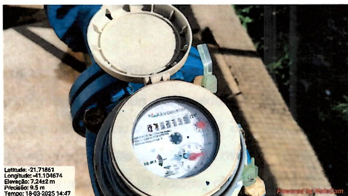
Foto 89: Medidor de vazão.
