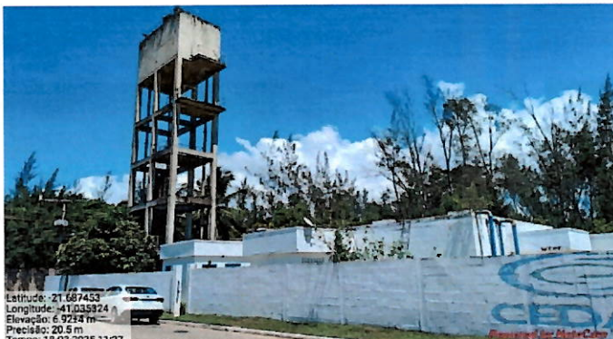
Foto 40: UT SESC (ausência de placa de identificação).
