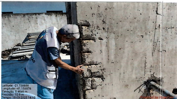
Foto 84: Estrutura do reservatório necessitando de reforma.
