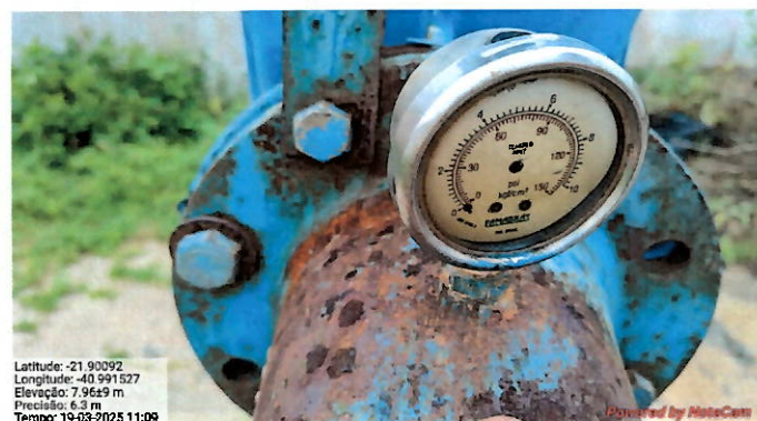
Foto 118: Medidor de pressão (danificado).
