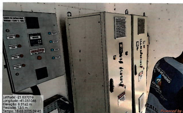
Foto 24: Painéis elétricos dos conjuntos motobomba.
