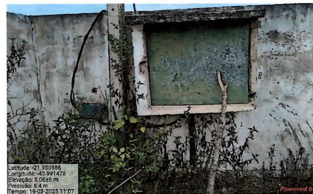
Foto 119: Tampa do quadro elétrico sendo escorada por galho de árvore.
