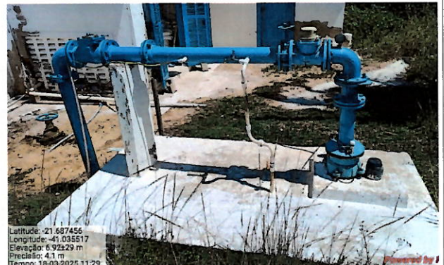
Foto 41: Poço de captação.
