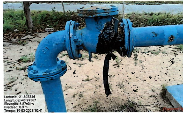
Foto 108: intervenção sem observância das boas práticas de manutenção.
