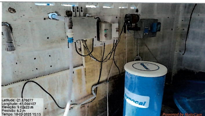
Foto 71: Sistema de tratamento.
