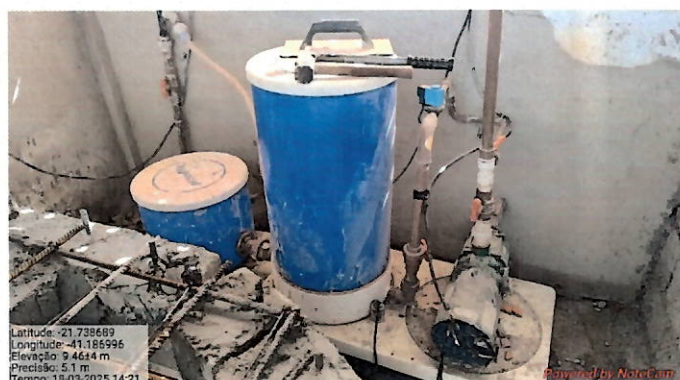
Foto 79: Sistema de cloração.
