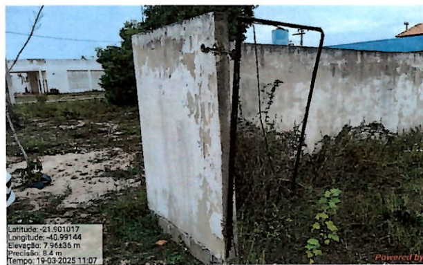
Foto 115: Ausência de portão.
