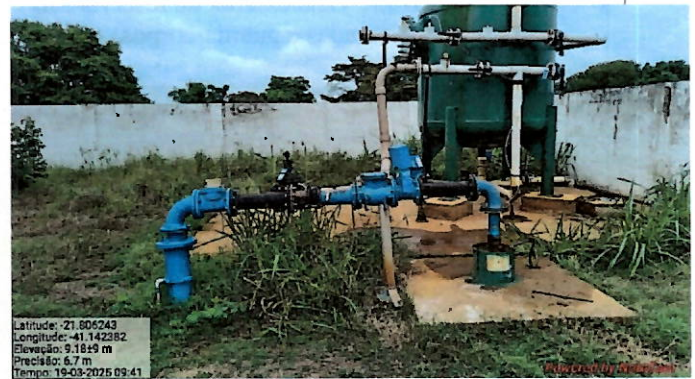
Foto 99: Poço de captação.
