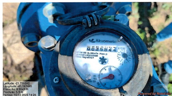
Foto 81: Medidor de vazão.
