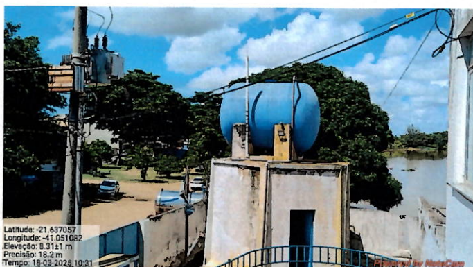
Foto 28: Tanque de armazenamento de Sulfato de Alumínio de 15.000 litros (ausência de bacia de contenção).
