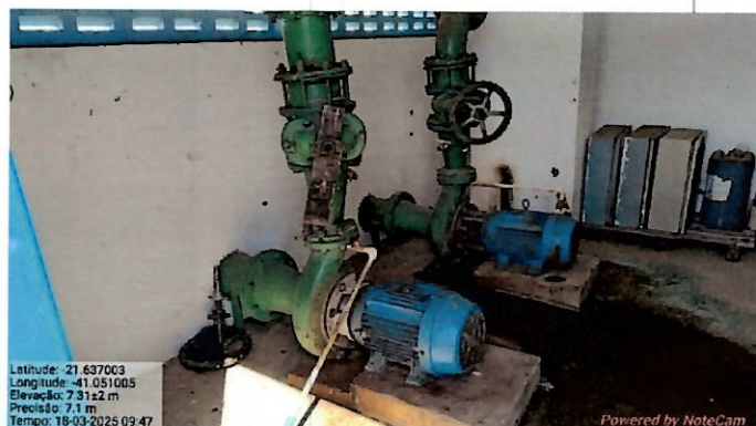
Foto 22: Conjuntos motobombas de 20 CV.
