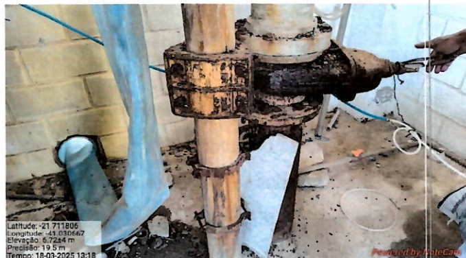
Foto 58: Interior (necessidade de manutenção).
