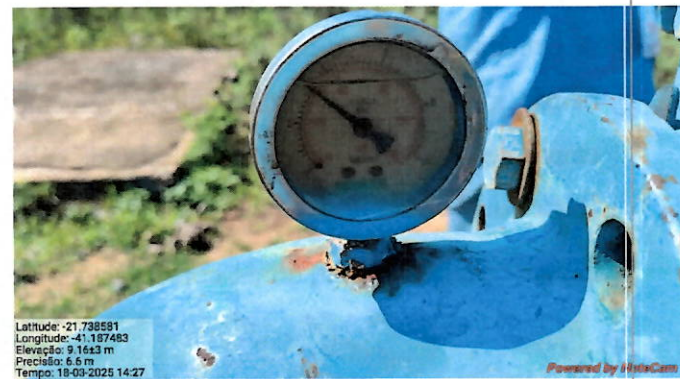
Foto 82: Medidor de pressão.
