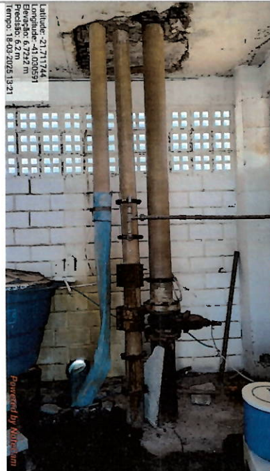
Foto 56: Interior (necessidade de manutenção).
