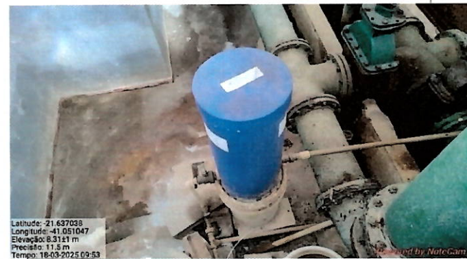
Foto 20: Sistema de cloração secundário.
