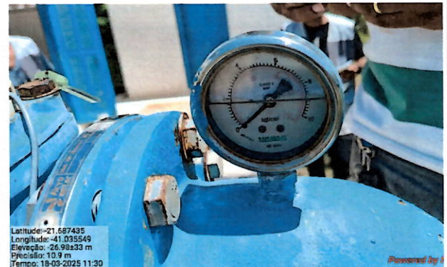
Foto 43: Medidor de pressão danificado.
