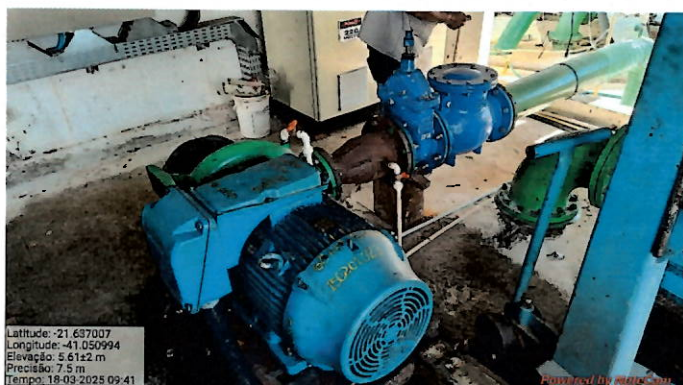
Foto 21: Conjunto motobomba de 60 CV (sendo utilizado como teste).
