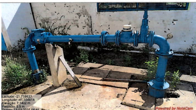
Foto 87: Poço de captação.
