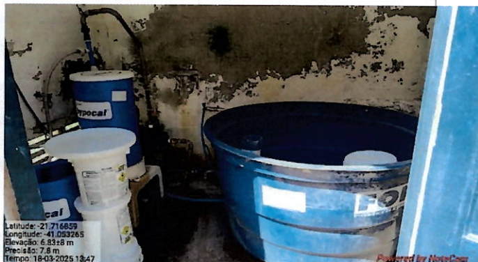
Foto 64: Sistema de tratamento.
