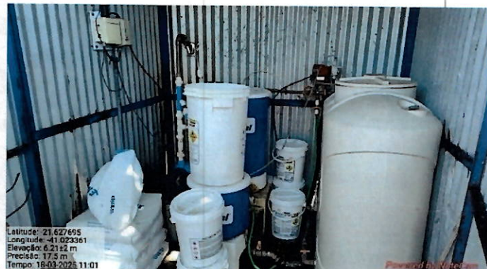
Foto 39: Sistema de tratamento.
