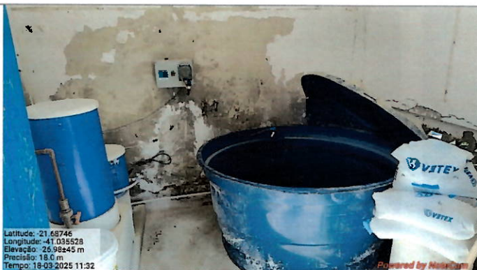
Foto 44: Sistema de tratamento.
