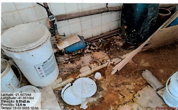
Foto 31: Vazamento do produto.
