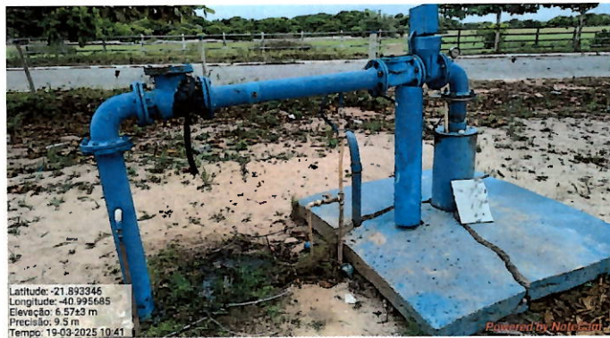
Foto 107: Poço de captação.
