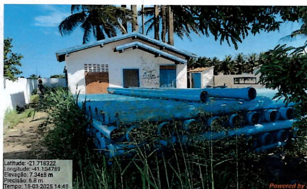
Foto 86: Armazenamento de tubulação que será utilizada na expansão da rede.
