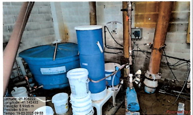
Foto 101: Sistema de tratamento.
