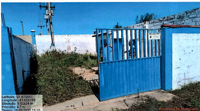
Foto 67: Entrada da UT (ausência de placa de identificação).
