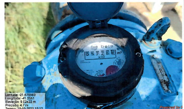
Foto 70: Medidor de vazão.
