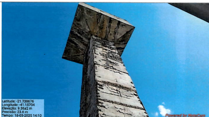
Foto 83: Estrutura do reservatório necessitando de reforma.
