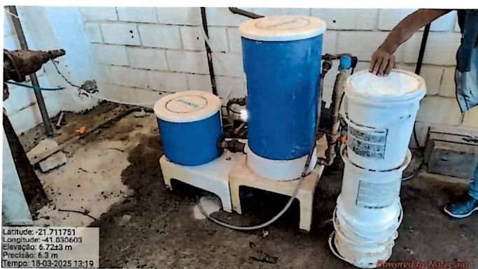
Foto 53: Sistema de tratamento.
