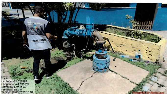
Foto 36: Poço de captação.
