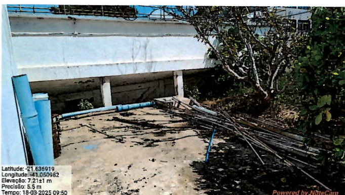
Foto 11: Materiais e bens inservíveis armazenados de maneira inadequada.
