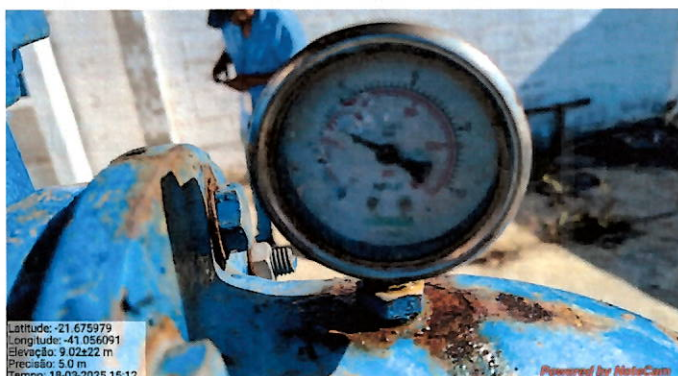
Foto 69: Medidor de pressão.
