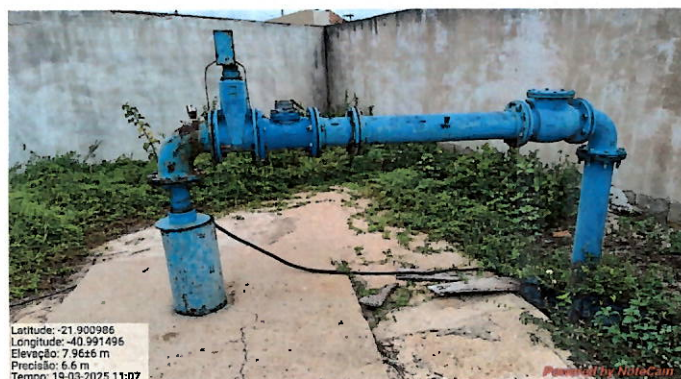
Foto 116: Poço de captação.
