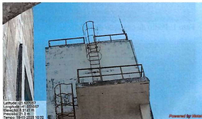
Foto 6: Sistema de Proteção contra Descargas Atmosféricas (SPDA) instalado.
