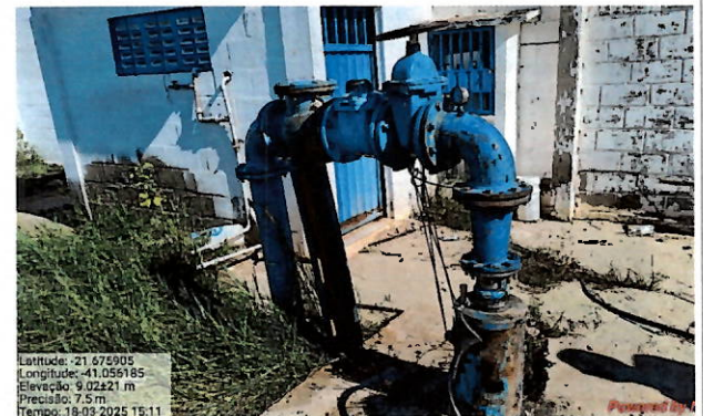
Foto 68: Poço de captação.
