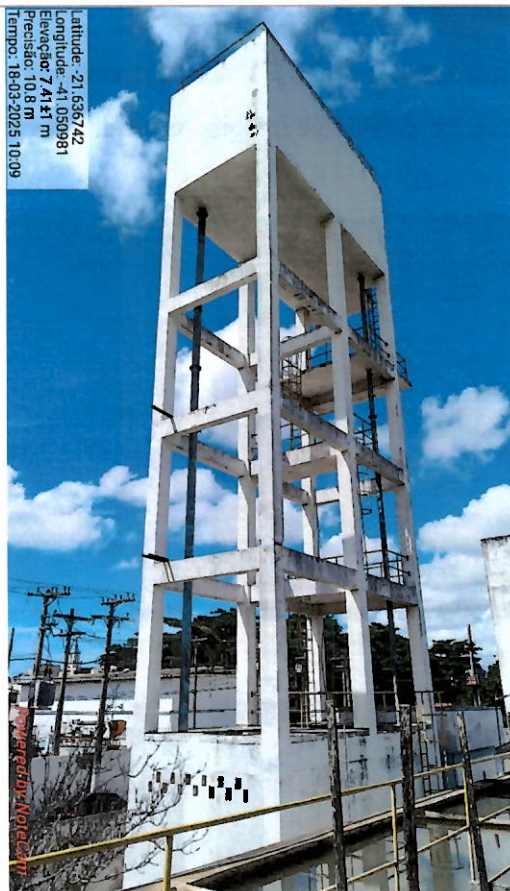
Foto 25: Reservatório de água tratada (110 m 3 )
