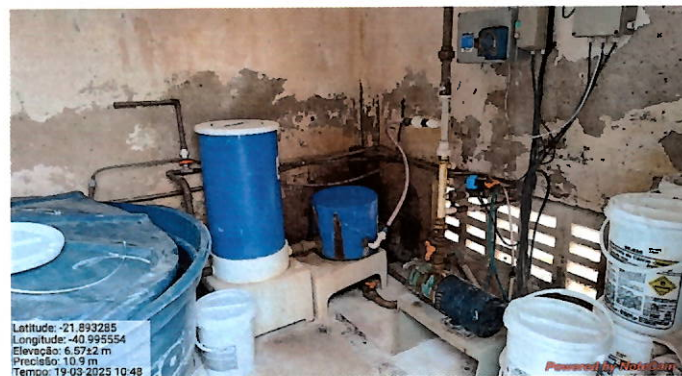
Foto 109: Sistema de tratamento
