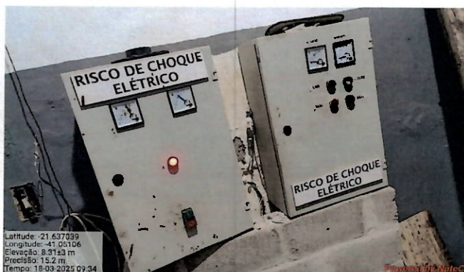
Foto 4: Painéis elétricos dos CMB.
