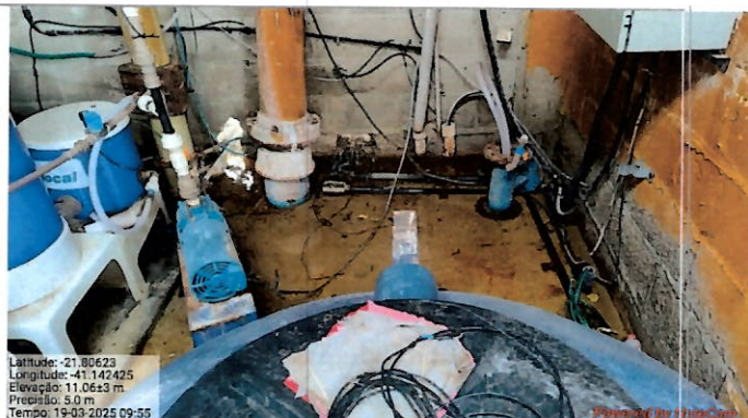
Foto 103: Fiação exposta em área alagada.
