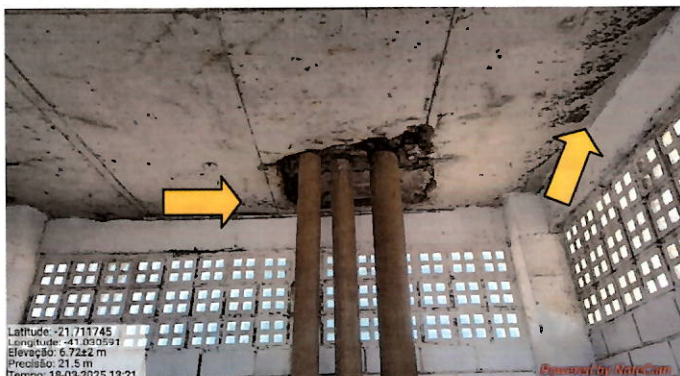
Foto 57: Interior (necessidade de manutenção).
