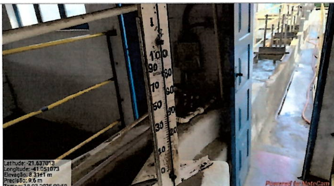
Foto 15: Medidor de vazão.
