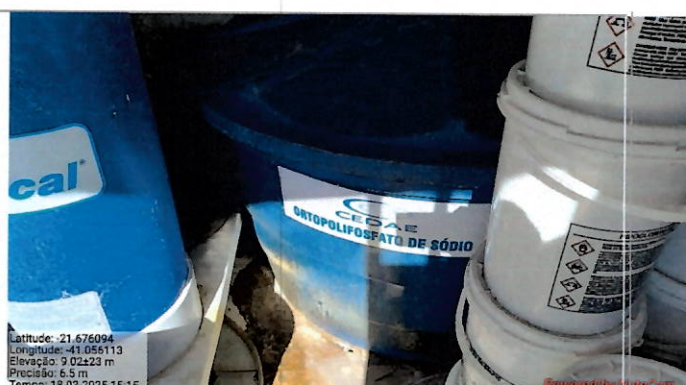
Foto 72: Sistema de tratamento.
