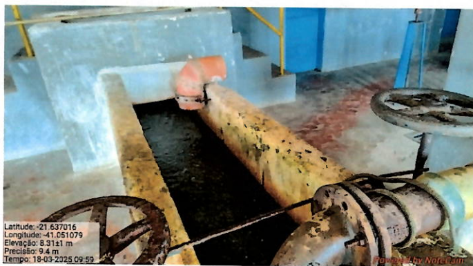
Foto 13: Entrada de água bruta no sistema de tratamento.
