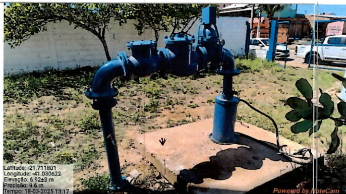
Foto 52: Poço de captação.
