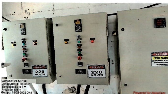
Foto 23: Painéis elétricos dos conjuntos motobomba.
