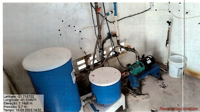
Foto 90: Sistema de cloração.
