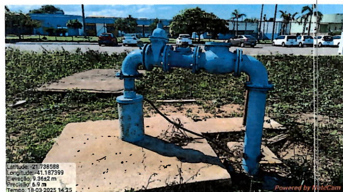
Foto 80: Poço de captação.
