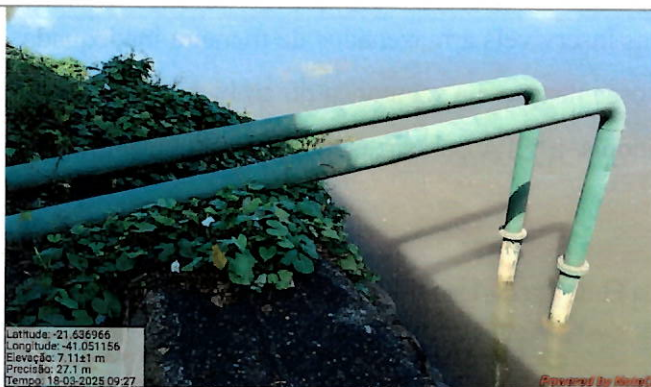
Foto 1: Ponto de captação dos CMB da EEAB.
