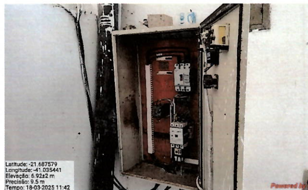
Foto 50: Quadro elétrico dos CMB.
