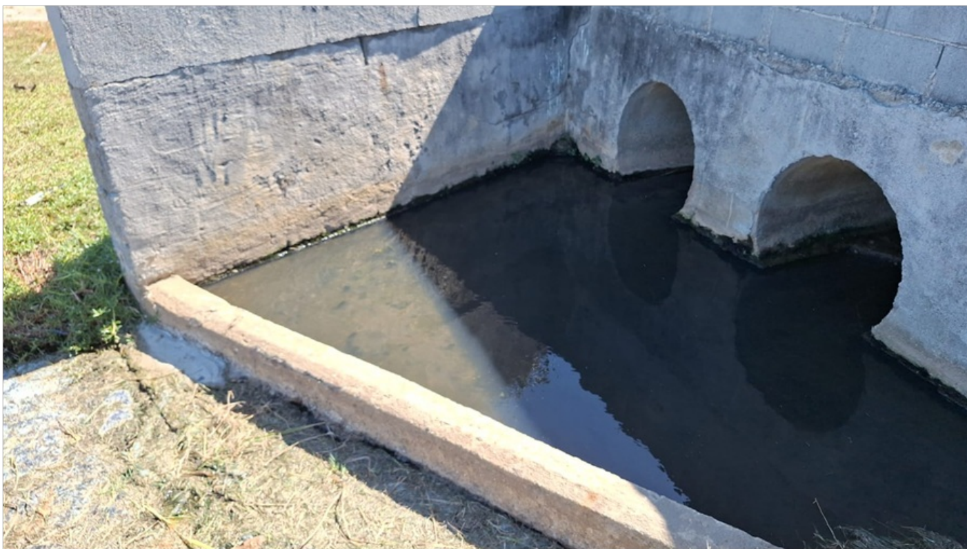
Foto 6 – Vista da captação em tempo seco (CTS) da Praia da Thereza com pequeno vazamento sob o vertedor.
