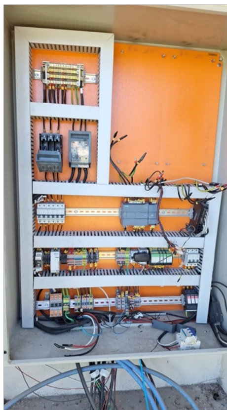
Foto 3 e 4 - Quadro elétrico com telemetria, proteção e inversor de frequência.
