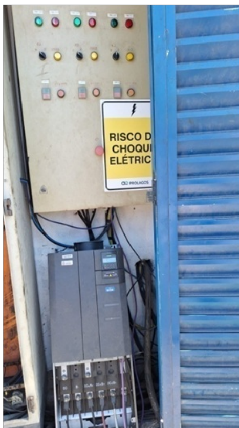
Fotos 4 e 5 – Quadro elétrico com telemetria, proteção e inversor de frequência
