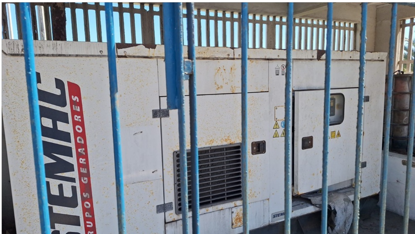
Foto 6 – Gerador com reservatório de óleo diesel com baia de contenção, a direita.
