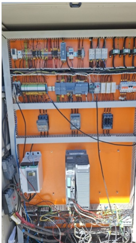
Fotos 3, 4 – Gerador , quadro elétrico com telemetria, proteção e inversor de frequência
