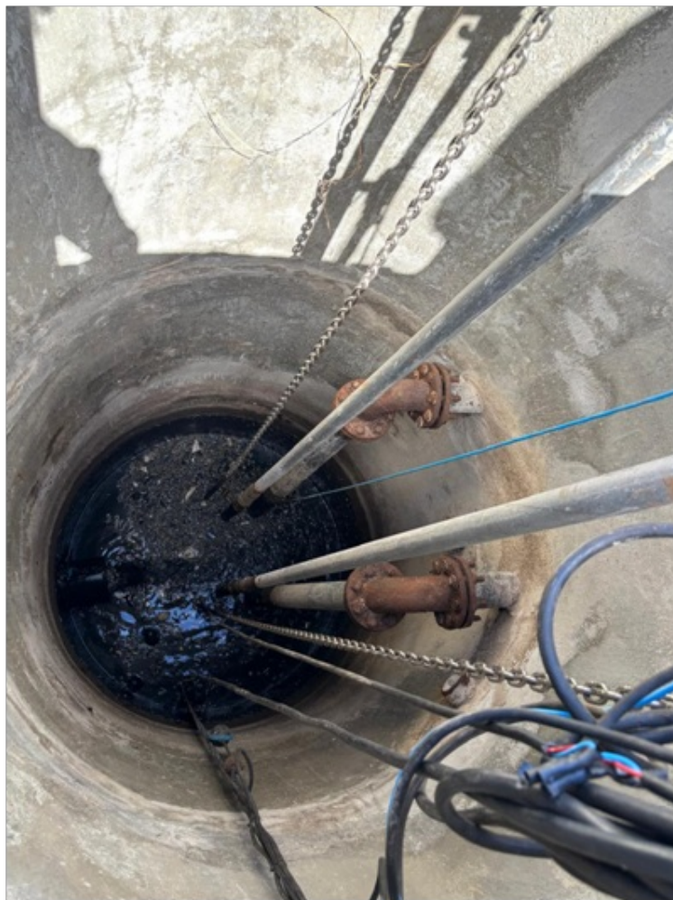
Foto 3 – Poço de sucção
