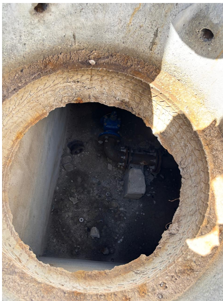
Foto 6 – Barrilete da elevatória
