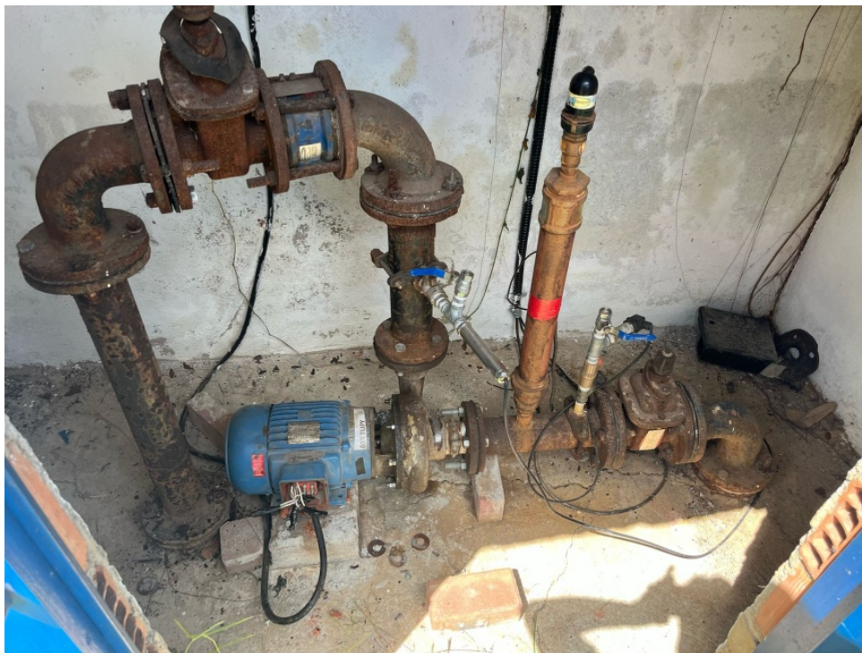
Foto 48 – Visualização da parte interna da unidade e equipamentos instalados
