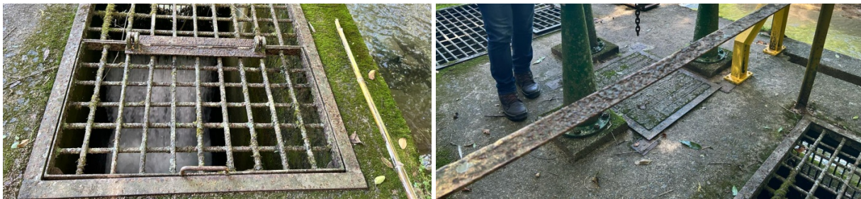
Fotos 8 e 9 - Sistema de gradeamento e válvulas regularizadoras de vazão
