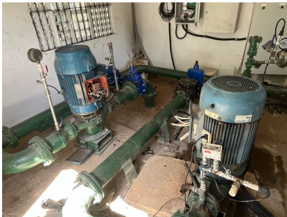
Foto 44 – Visualização da parte interna da unidade com visualização dos conjuntos motobombas
