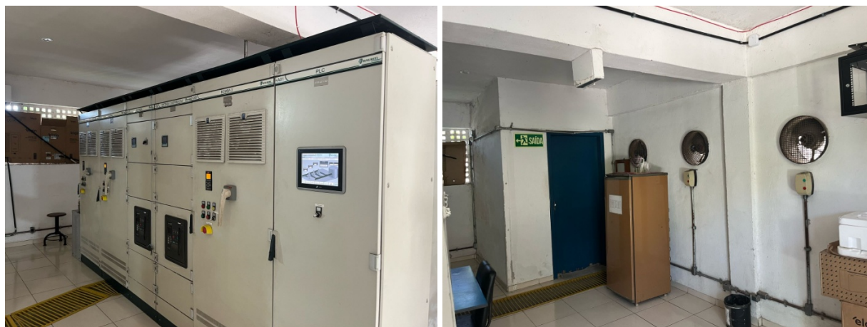
Fotos 33 e 34 – Painéis de automação e outras instalações da unidade
