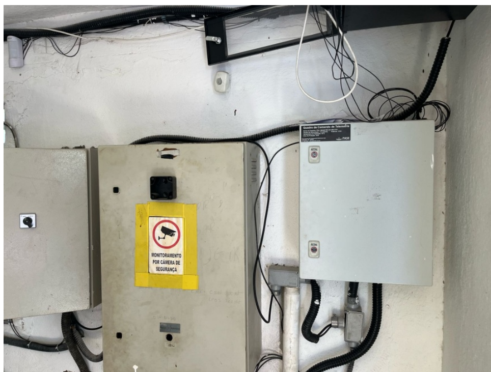
Foto 45 – Visualização dos painéis elétrico e de automação sem sinalização de risco
