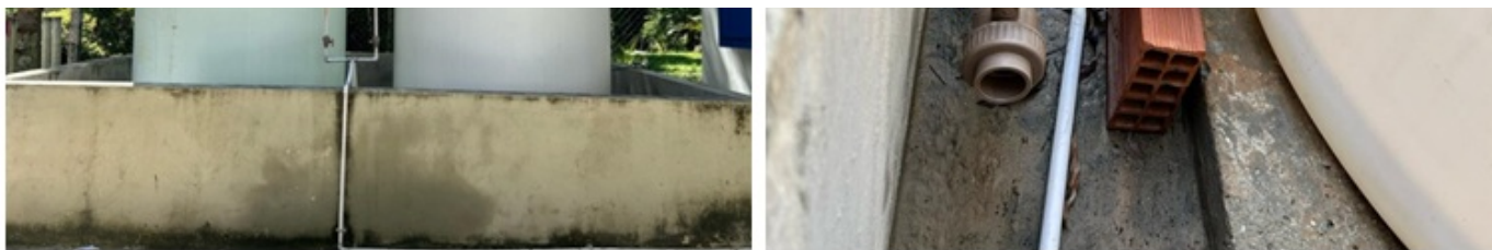
Fotos 19 e 20 – Tanques de armazenamento de hipoclorito de sódio
