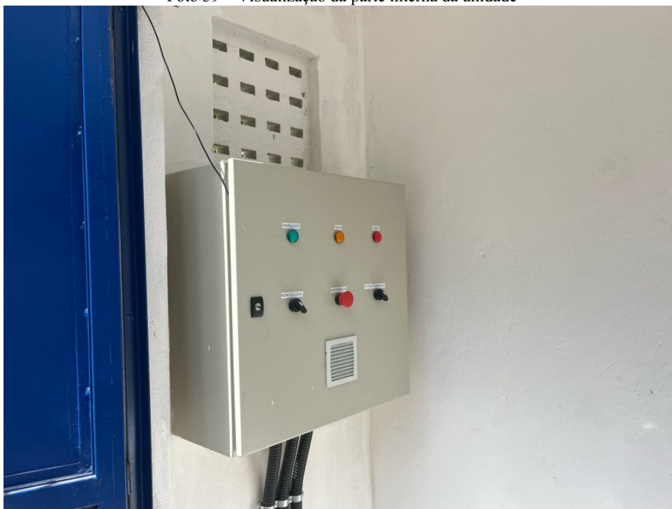
Foto 40 – Pannel de automação sem sinalização de risco
