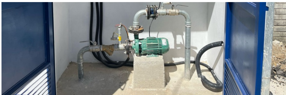
Foto 37 – Visualização da parte interna da unidade e falta de sinalização de risco no painel de automação
