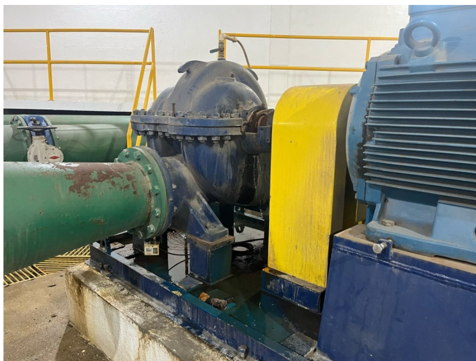
Foto 35 – Identificação de vazamento em um dos conjuntos motobombas
