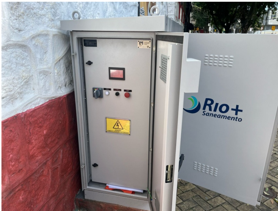
Foto 30 – Equipamentos elétricos com as devidas sinalizações de risco
