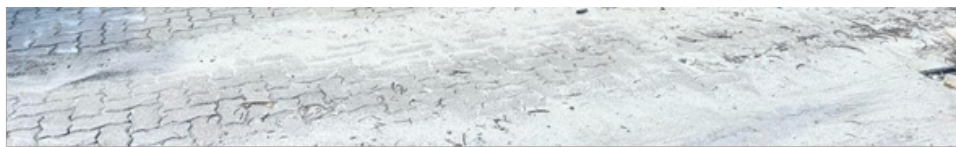
Foto 4 – Materiais em local inapropriado
