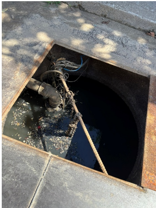
Foto 11- Poço das Bombas (está operando com uma bomba submersível e outra na reserva )
