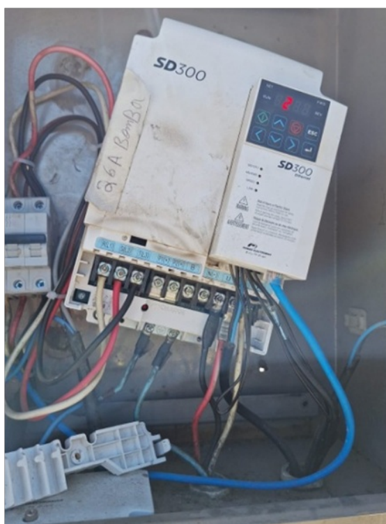
Foto 7 - Componente A – Inversor de Frequência solto
