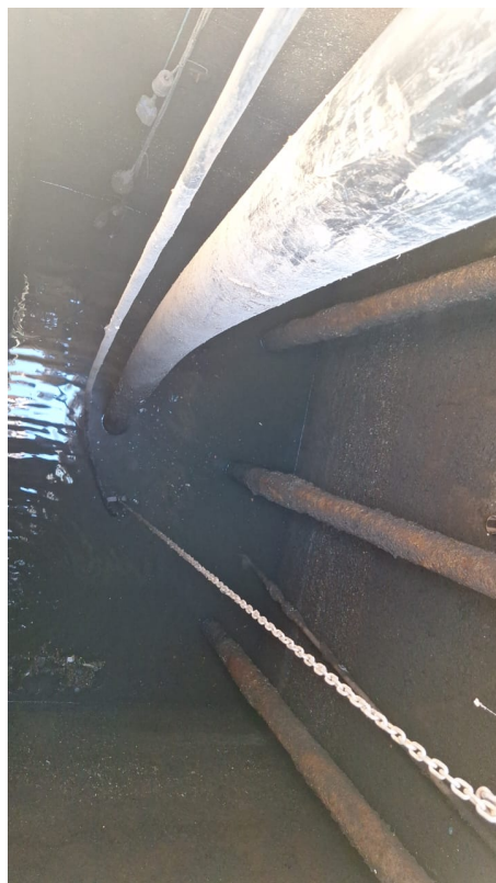
Foto 6- Poço das Bombas ( está operando com uma bomba submersível ).
