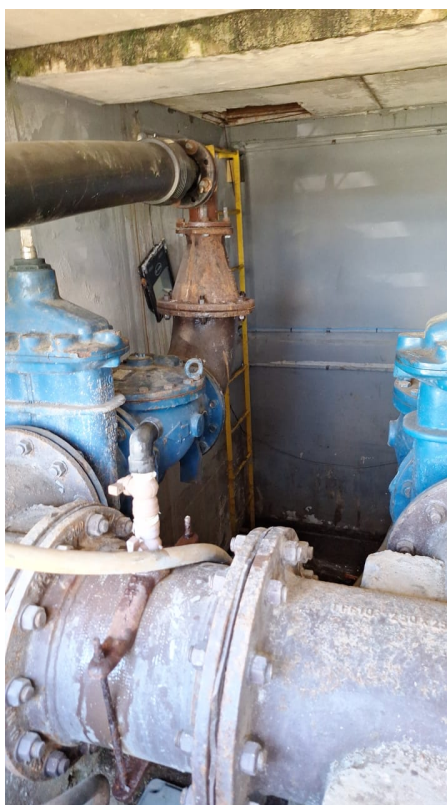
Foto 5 - Barrilete da Elevatória
