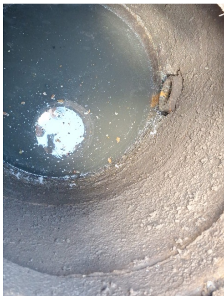
Foto 8 – PV com a saída afogada
