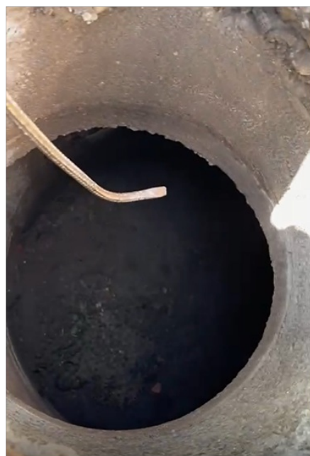
Foto 5 –PV cheio de sedimentos na Rua Cizino S. da Silva Lopes na esquina com Trav. Francisco Santos (Local 4)
