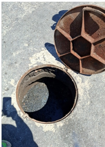
Foto 6 –PV cheio de sedimentos na Rua José Hidelfonso de Souza Ramos na esquina com Av. José Rascão (Local 5)
