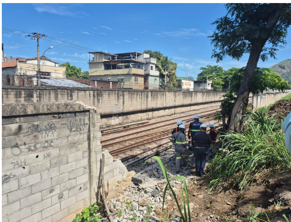
Foto 4 – Equipes da Águas do Rio e MetrôRio no local do rompimento
